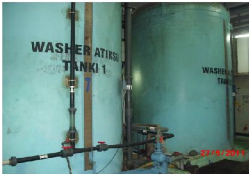
Şekil 6.1: Washer atık su tankları
