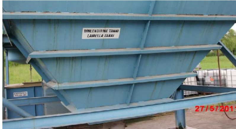
Şekil 5.1: Ön arıtma kimyasal çöktürme tankı
