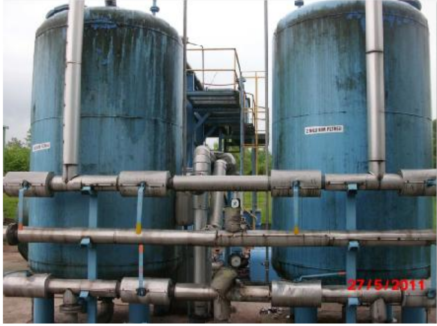
Şekil 5.2: Ön arıtma kum filtreleri
