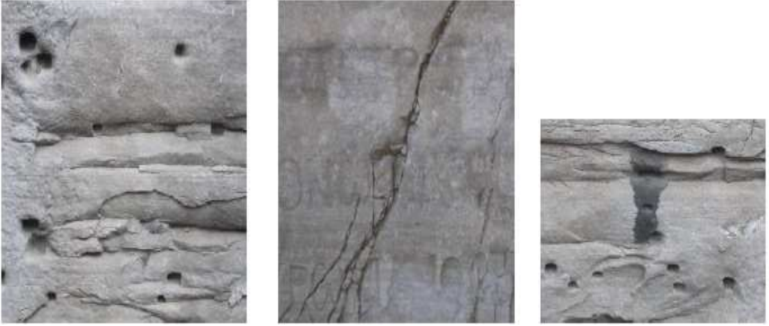
Şekil 37. Örne Dikilitaş'ın mermer kaidesi üzerindeki çatlamlar, yapraklanmalar ve alçıtaşı oluşumu (Tulgar, 2007)
