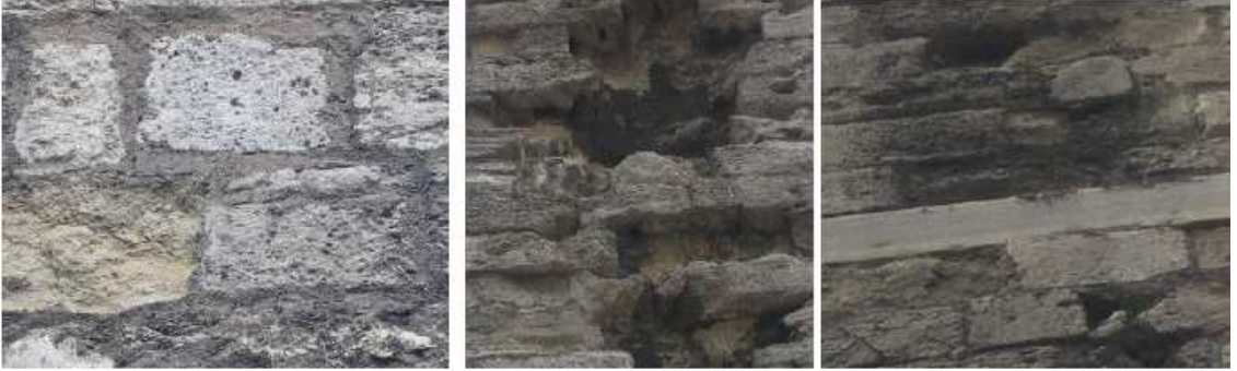
Şekil 32. GB cephede eski onarımda kullanılmış olan modern portland çimento bağlayıcı derz dolguları ve taşlarda görülen yüzey erozyonu ve yapraklanma (Tulgar, 2007)
