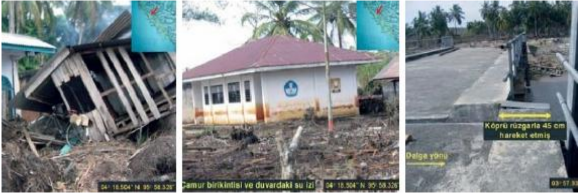
Şekil 6.2 Sumatra kıyılarında tsunami dalgalarının a)Ahşap yapılar, b)Betonarme yapılar, c) Altyapı üzerindeki hasar düzeyleri (Yalçiner, 2005)
