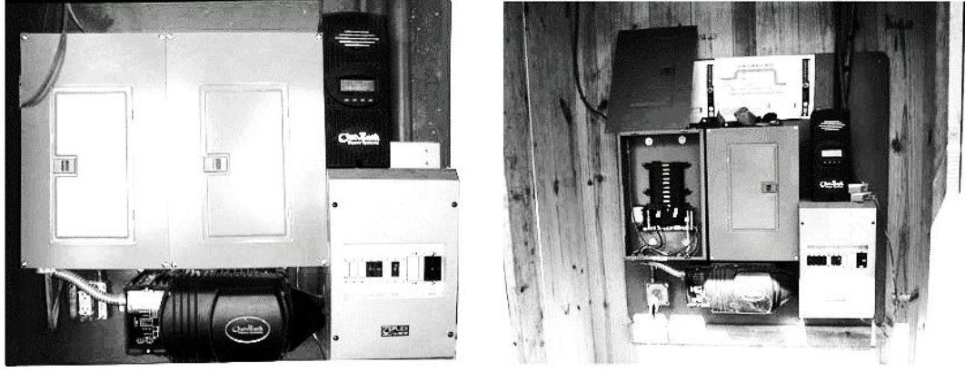
Resim 2.18. Güç Kontrol Ünitesi'ne (POM) Ait Görünüm (URL-16, 2016).
