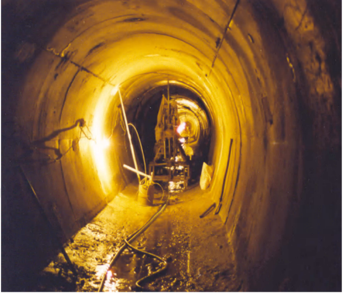
Şekil 4.4 4 Eylül Barajı'na ait derivasyon tüneli inşaatından bir görünüm ve öngörülen destekleme sistemi (Koruç, 2007).
