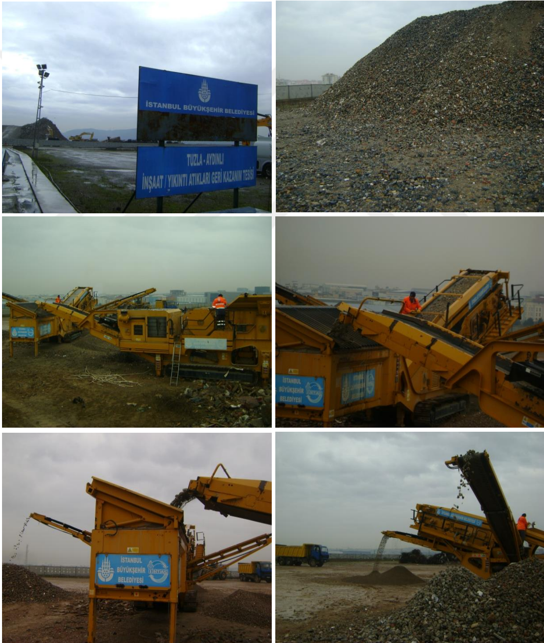
Şekil 3.7 Geri kazanım tesisi ve geri kazanım işleminin uygulama aşamaları
