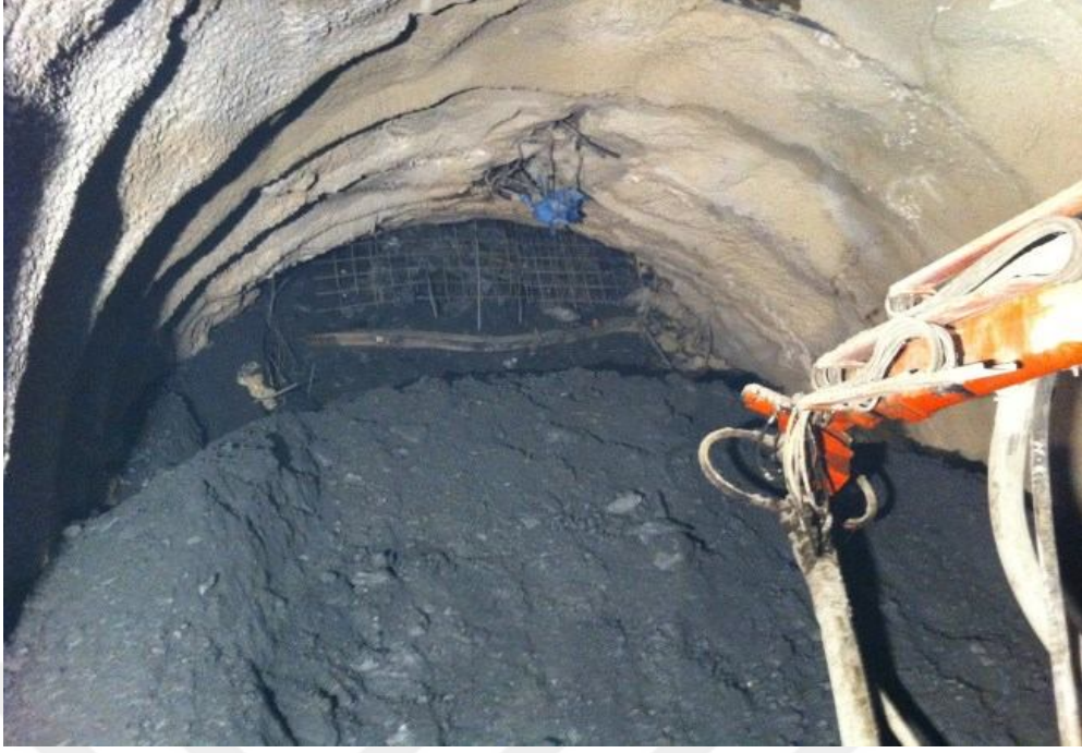
Şekil 4.27. T2 tüneline oluşmuş göçüğün görünümü
