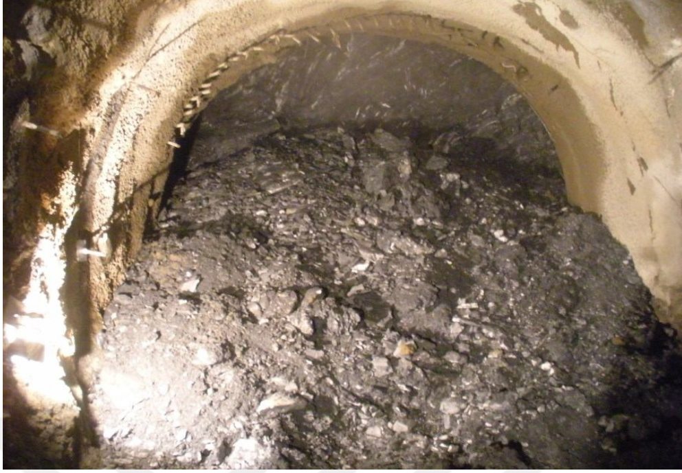
Şekil 4.30. T2 tüneline km: 1+267-1+263 arasında oluşan göçüğün görünümü
