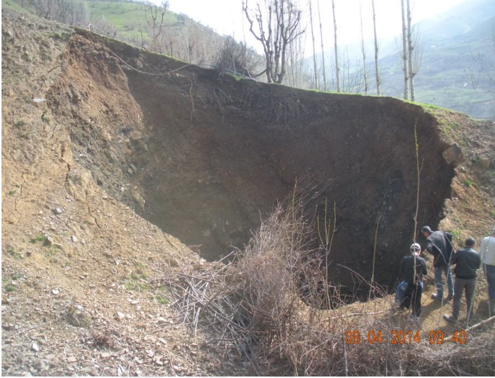
Şekil 4.12. T2 tüneline göçük nedeniyle yüzeyde oluşan bacanın görünümü.
