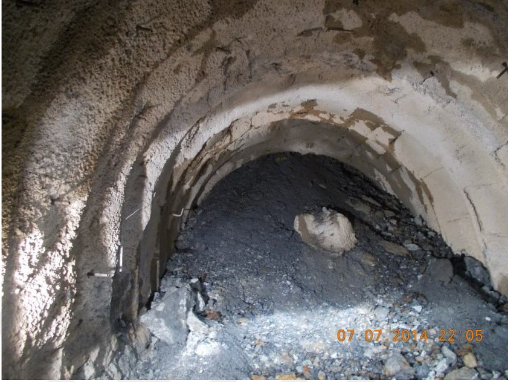
Şekil 4.15. T2 tüneline göçük zonlarında akan malzemenin görünümü
