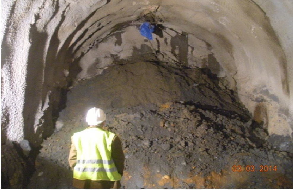
Şekil 4.23. T2 tünel aynasında meydana gelen göçük
