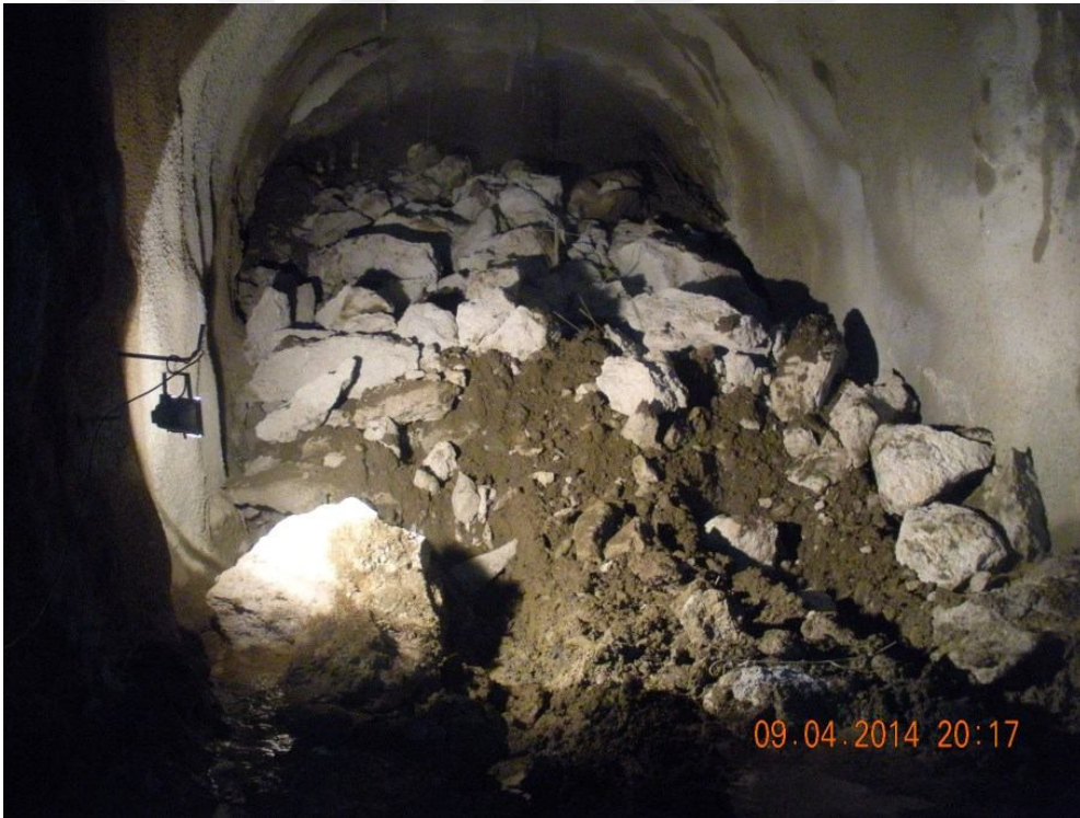
Şekil 4.10. T2 tüneline göçük nedeniyle tünel içerisine akan malzemenin genel görünümü
