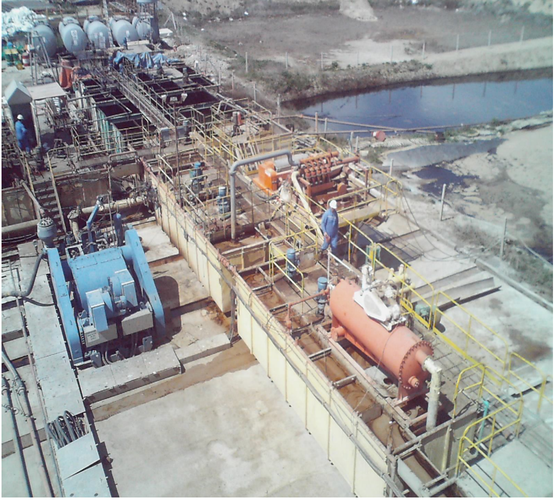
Şekil 3.12. Karıştırıcılar ve Çamur Pompalarından Bir Görüntü
