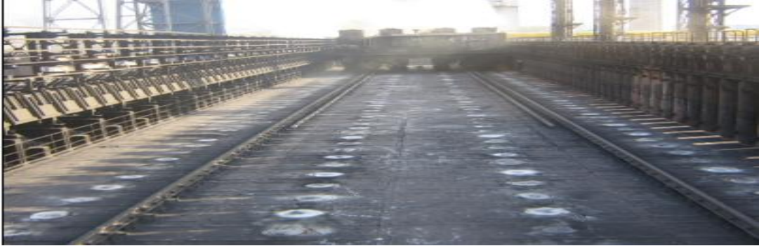
Şekil 2.4. 6 Nolu batarya şarj katı
