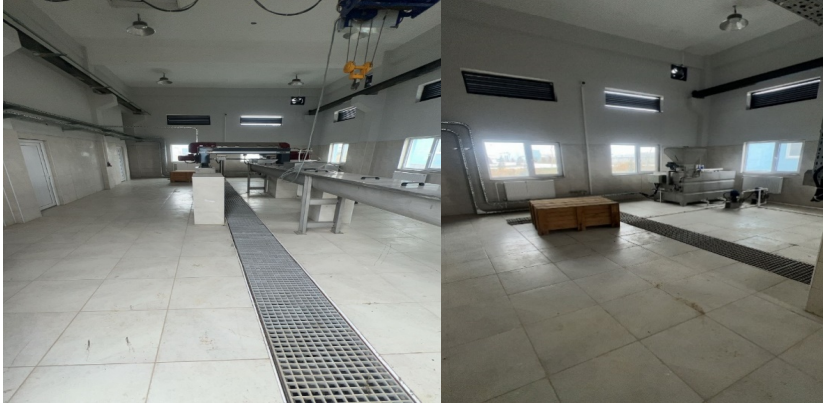
Şekil 3.7 Muradiye atıksu arıtma tesisi çamur susuzlaştırma ünitesi
