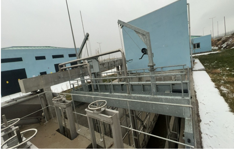
Şekil 3.2 Muradiye atıksu arıtma tesisinin kum ve yağ tutucu ünitesi
