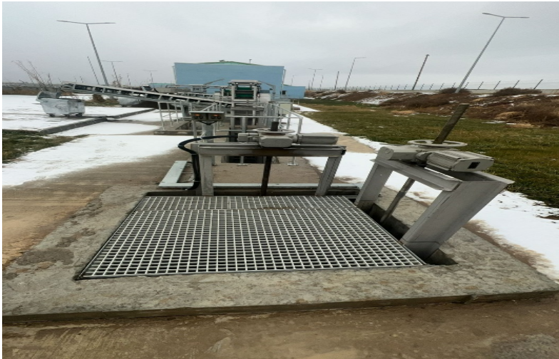
Şekil 3.1 Muradiye atıksu arıtma tesisi giriş ünitesi
