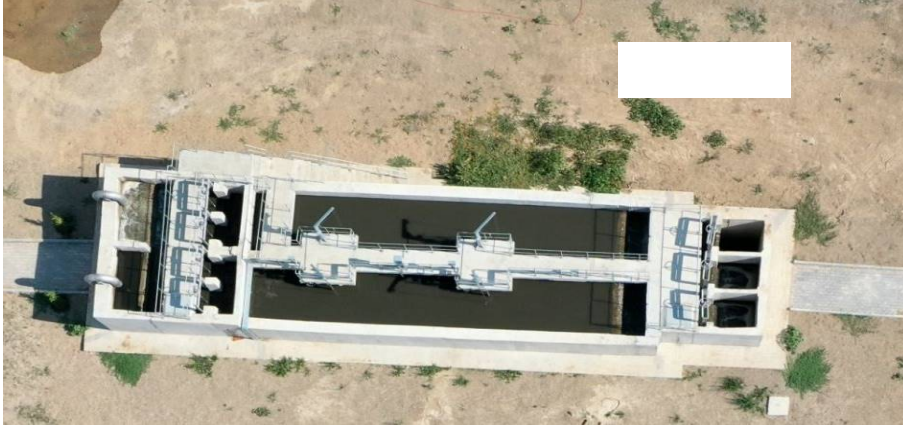
Şekil 3.3 Muradiye atıksu arıtma tesisine ait anaerobik ünite
