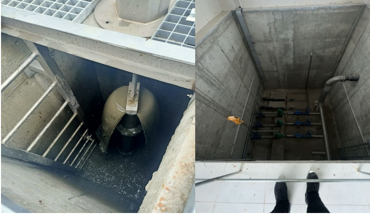
Şekil 3.6 Muradiye atıksu arıtma tesisi geri devir yapısı
