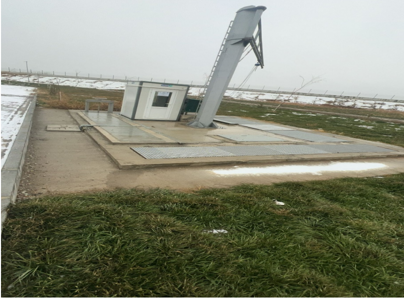
Şekil 3.8 Muradiye atıksu arıtma tesisine ait Ultraviyole (UV) ünite
