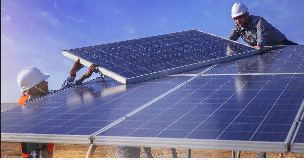
Şekil 2.6 Fotovoltaik Sistem Kurulumu (URL 7).
