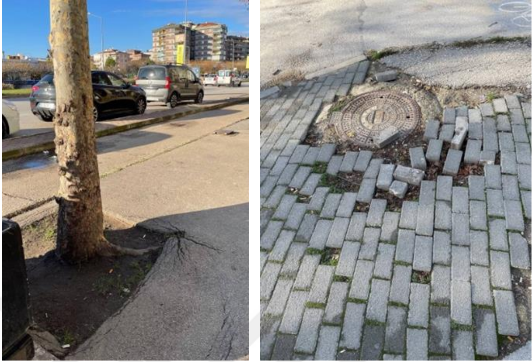
Şekil 5.11 : Kaldırım malzemelerindeki kabarma ve kopmalar.
