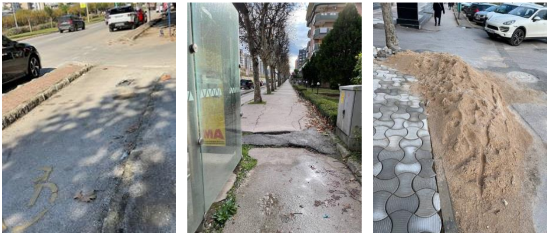
Şekil 5.27 : Kaldırım üzerinde düşme tehlikesi taşıyan kısımlar.
