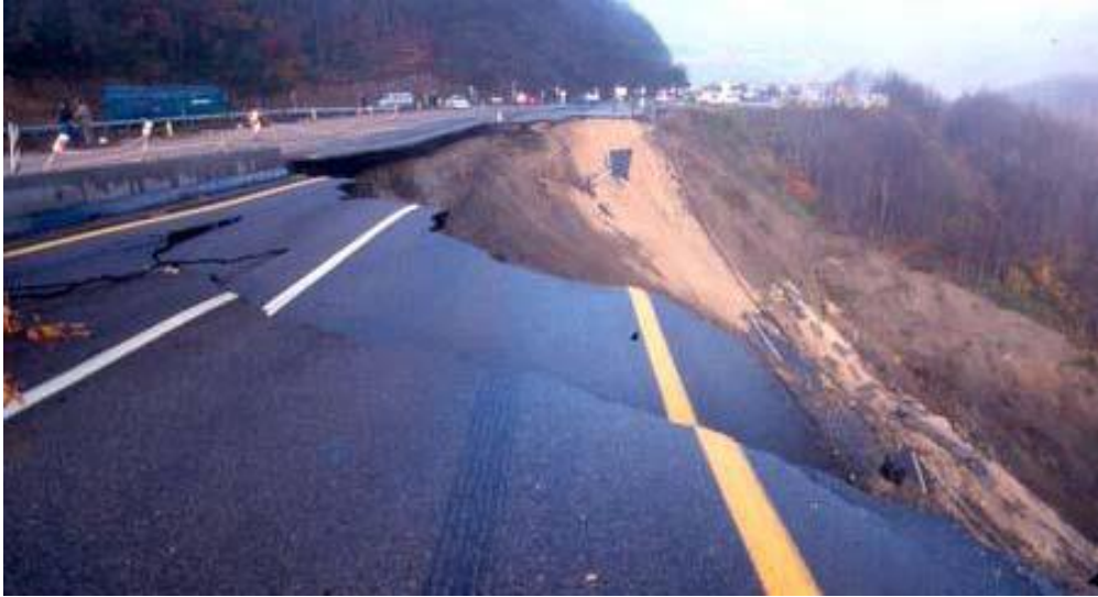
Şekil 27. 12 Kasım 1999 Düzce depremi E-5 Bolu geçişi karayolu hasarı (Balyemez ve Berköz, 2005: 4).
