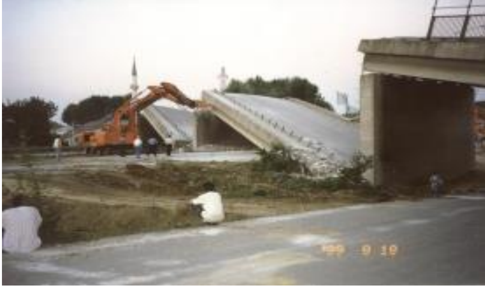
Şekil 28. Kocaeli depremi viyadük çökmesi (Sucuoğlu, 2000: 10).
