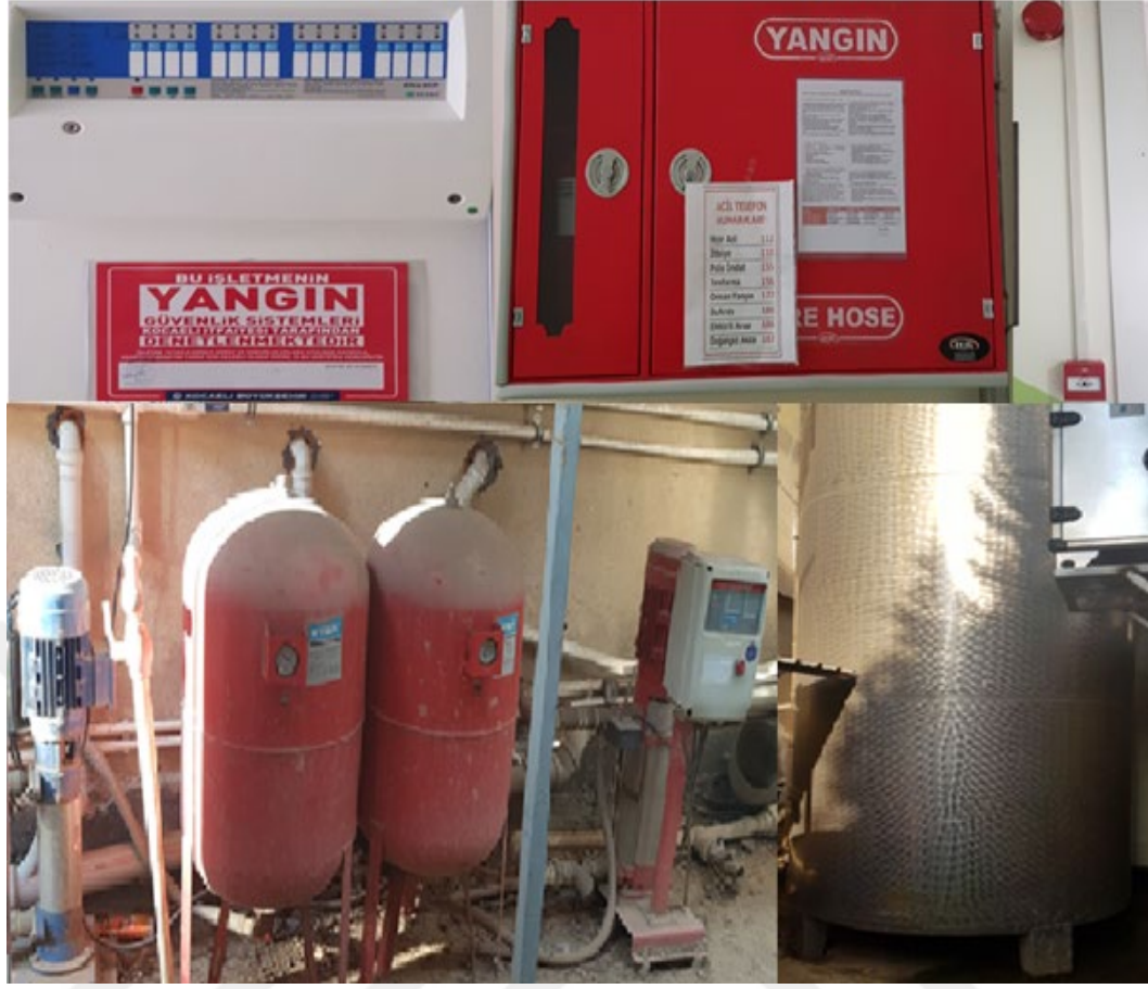
Şekil 6.2. Okulda Mevcut Bulunan Duman Algılama ve İhbar Sistemi, Kontrol Paneli, Yangın Hortum Dolabı, Manuel İhbar Butonları, Yangın Pompa Gurubu, Yangın Pompalarını Besleyen Su Deposu
