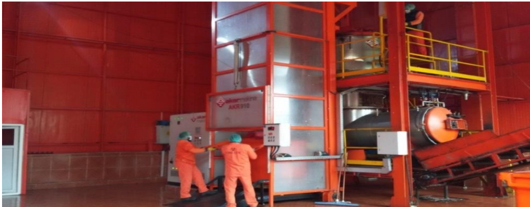
Şekil 4.24. Şanlıurfa ili Tıbbi Atık Sterilizasyon Tesisi içten görünüm
