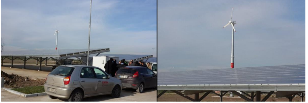
Şekil 5.2. Katip Çelebi Üniversitesi otopark alanı güneş panelleri ve rüzgar türbini uygulaması (İzmir Katip Çelebi Üniversitesi, 2015)
