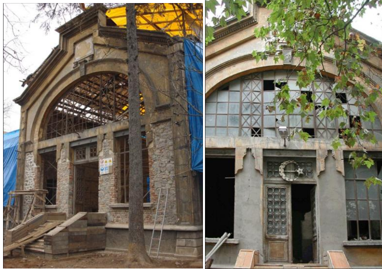
Şekil 19: Cendere Su Pompa İstasyonu
