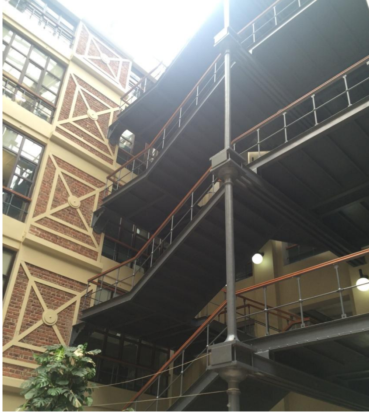
Şekil 161: B Bloktaki iç avluda bulunan çelik konstrüksiyon güçlendirme elemanları
