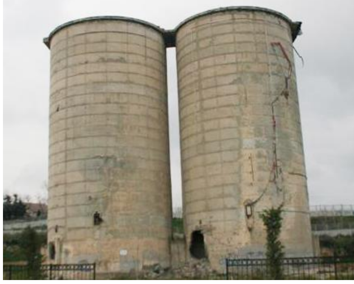
Şekil 87: Yunus Çimento Fabrikası Atıl kalan ve yıkılan bacaları
