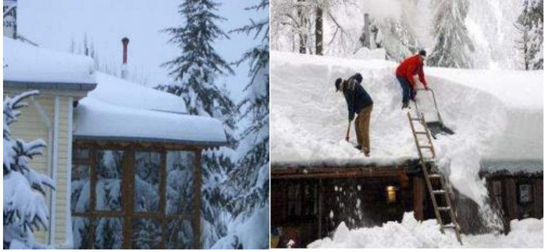
Şekil 4.1: Kar yığılmış bir konut çatısı ve temizleme çalışması [10]
