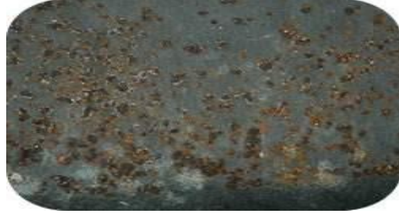
Şekil 2.13. Çukurcuk Pitting Korozyonu (Anonim 2015b)
