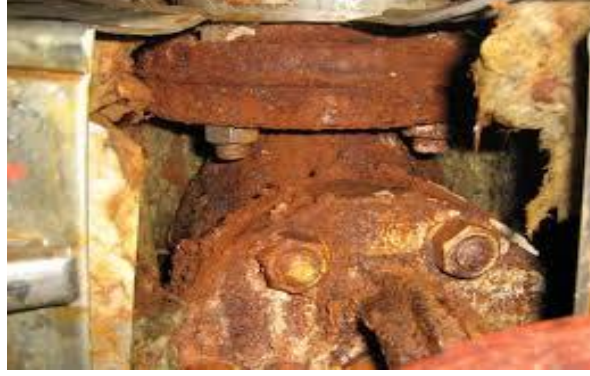
Şekil 2.16. Farklı metaller arasında oluşan galvanik korozyonu (Anonim 2015c)
