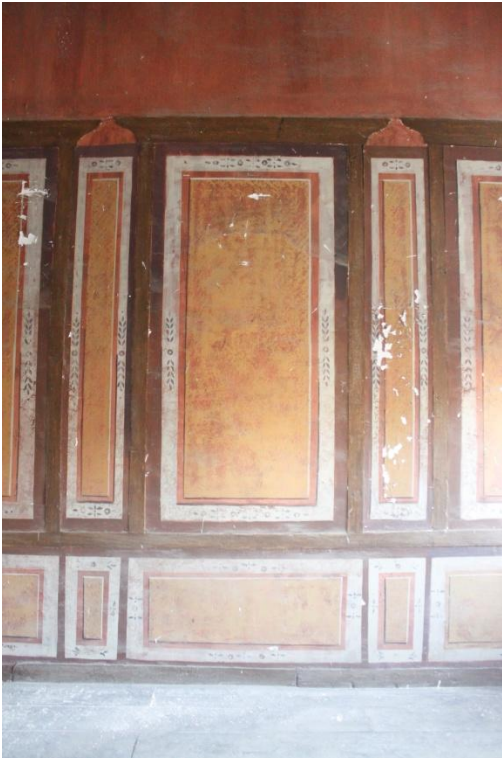
Şekil C 103. 1K02 batı duvarı üzeri ahşap çerçeveler.
