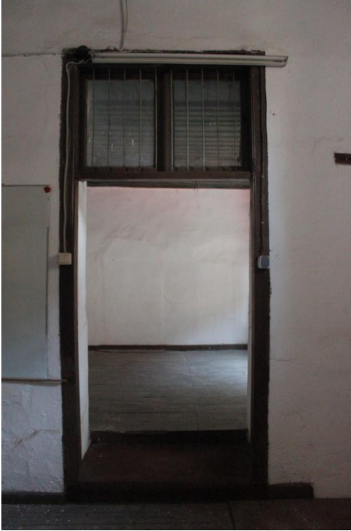
Şekil C 286. Z04 ve Z05 mekanları arası özgün olmayan kapı boşluğu.
