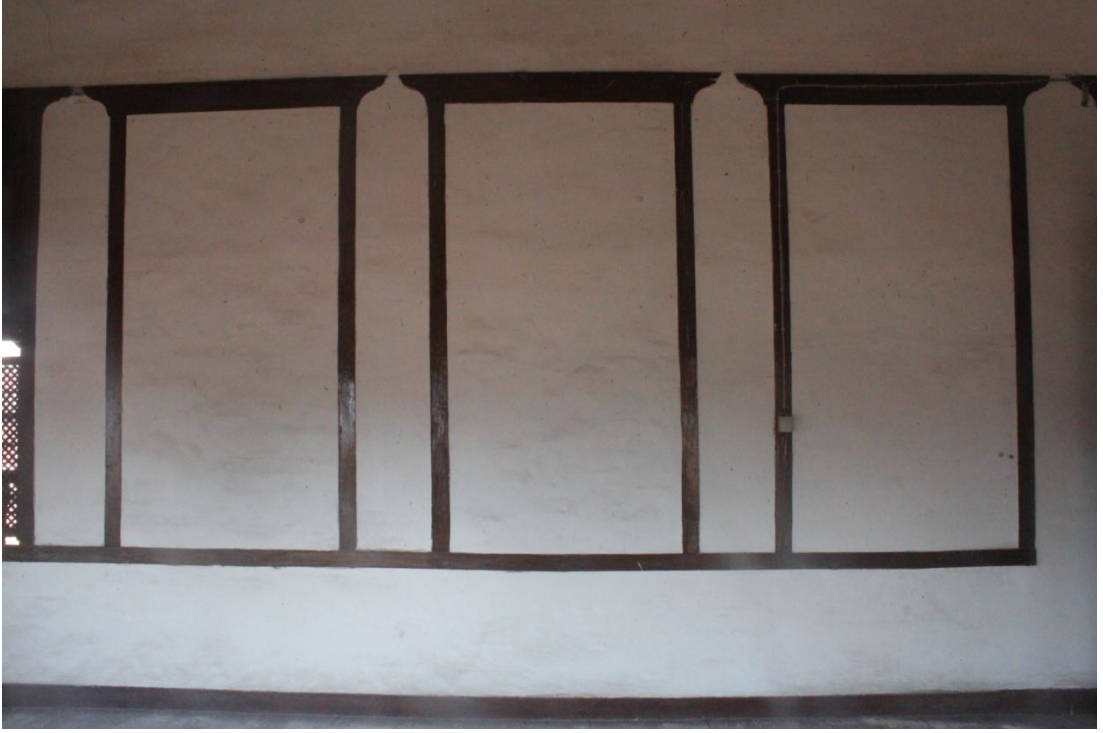
Şekil C 97. 1K01 doğu duvarı üzerinde ahşap çerçeveler.
