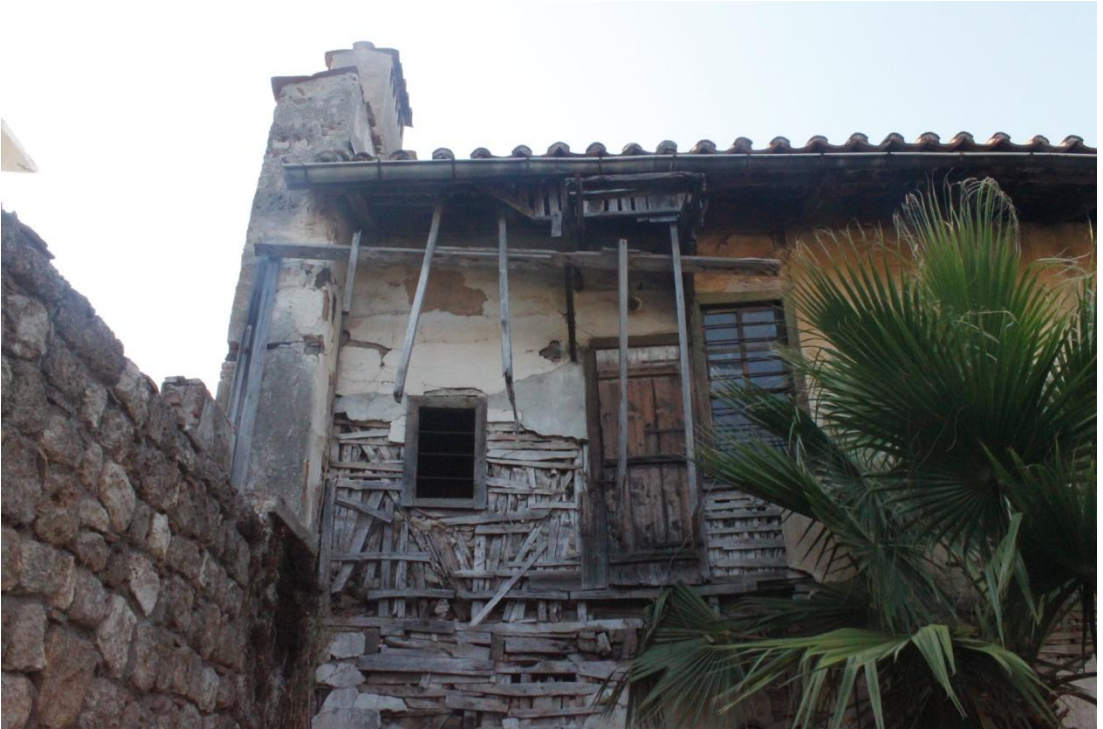
Şekil C 161. 1K09 mekanı yıkılmış teras bölümü.
