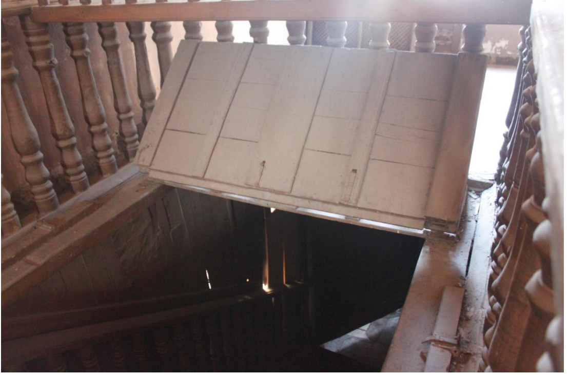
Şekil C 124. 1K04 merdiven kepenk sistemi.
