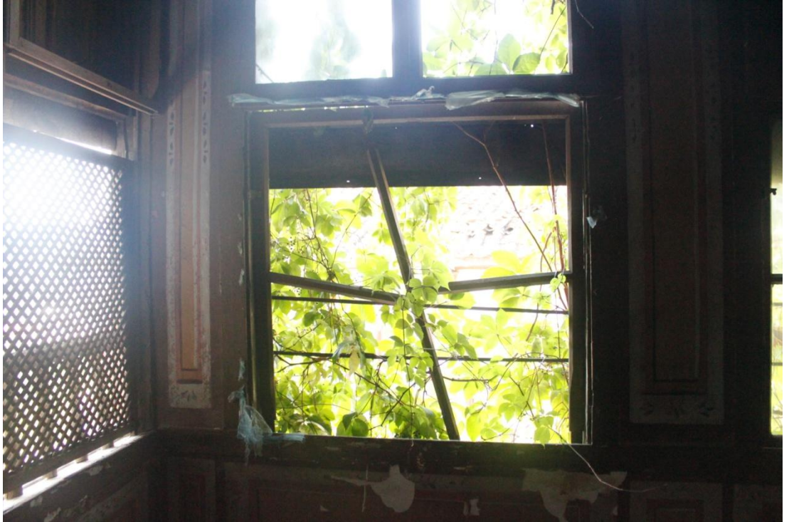
Şekil C 277. Hasarlı giyotin pencere.
