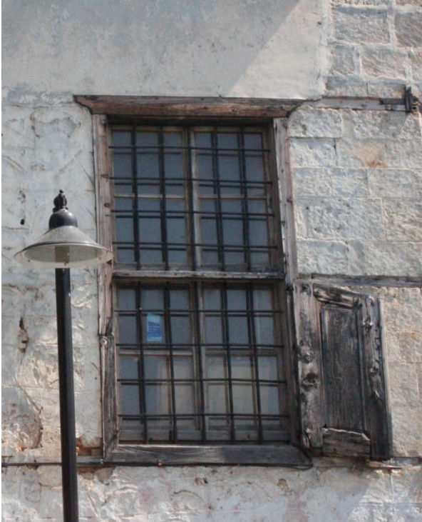
Şekil C 279. Yapı elemanı deformasyonu.
