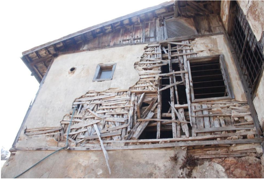
Şekil C 247. Doğu cephesi / Ek bina yıkılmış duvar.
