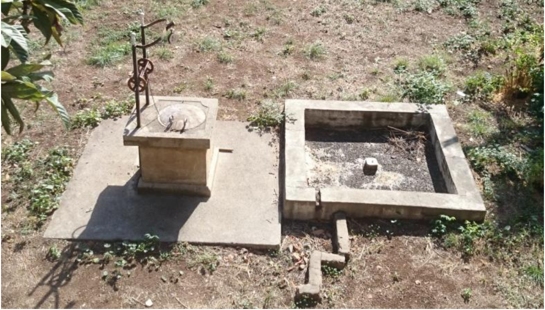
Şekil C 193. Kuyu ve havuz.
