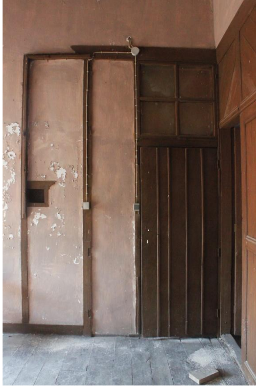
Şekil C 288. 1K06 mekanı değiştirilmiş kapı kanadı.
