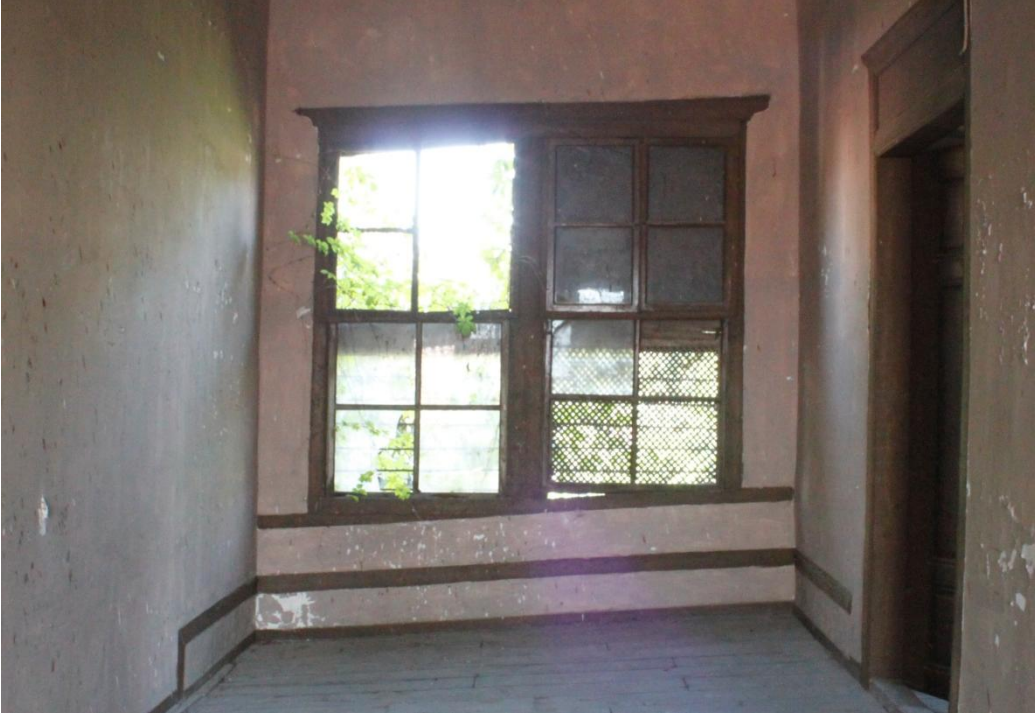
Şekil C 278. Strüktürel problemlere bağlı yapı elemanlarında oluşan deformasyon.
