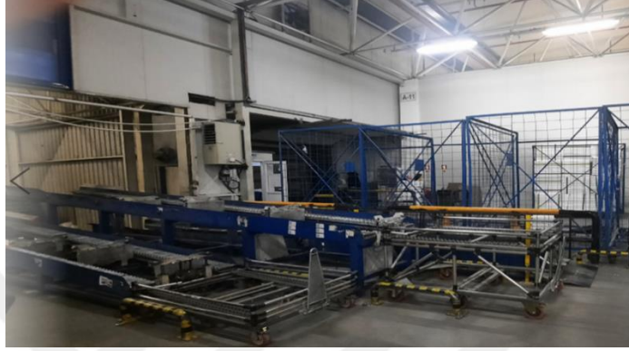
Şekil 7.42 : K550 Kasalı malzemelerin aktarım sistemi.
