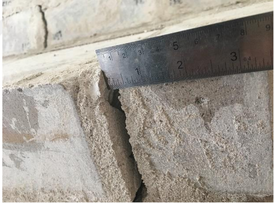
(e) Model-300 kubbe deney elemanında oluşan çatlak genişliği.
