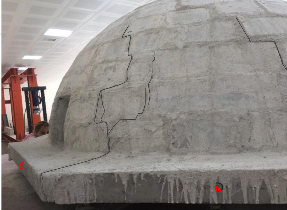
(e) 5.-6. kenarlardan başlayan çatlaklar.
