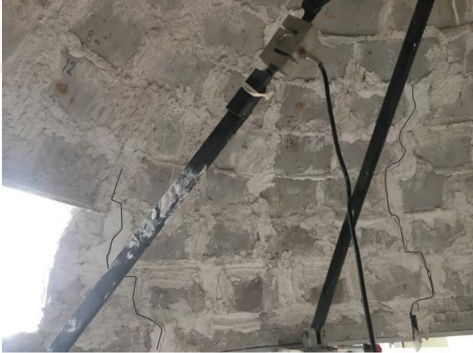
(i) Kubbe içinde oluşan çatlaklar.
