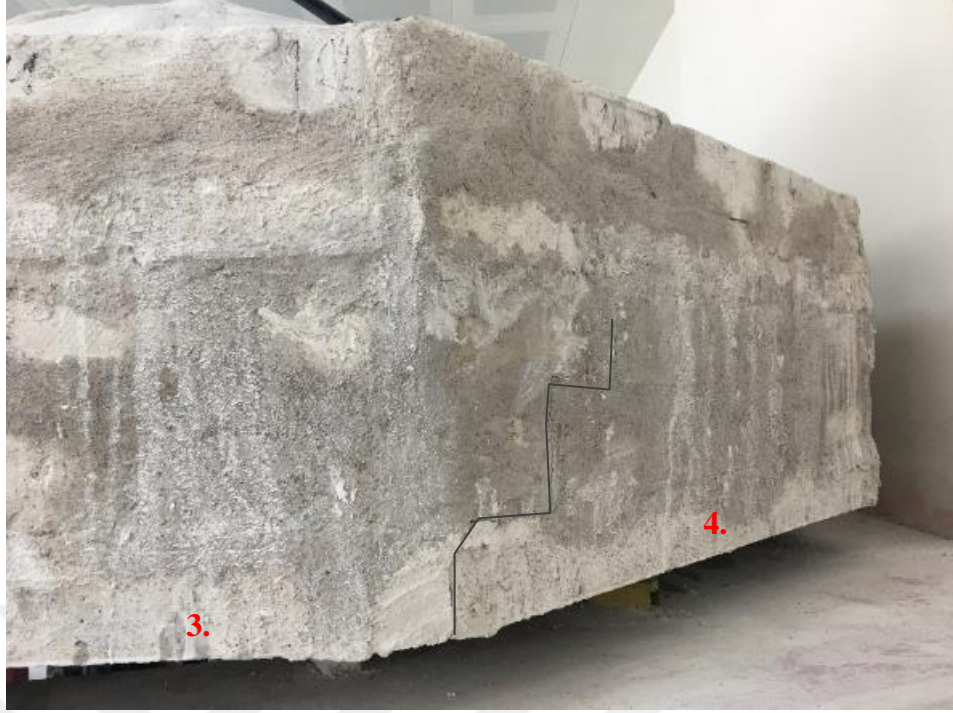
(d) 3.-4. kenarlardan başlayan çatlaklar.
