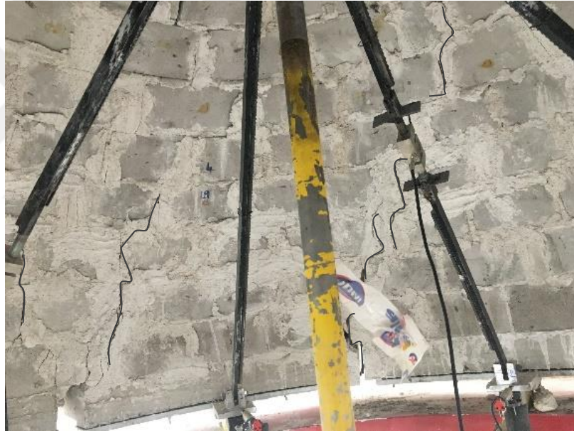
(f) Kubbe içerisinde oluşan çatlaklar.
