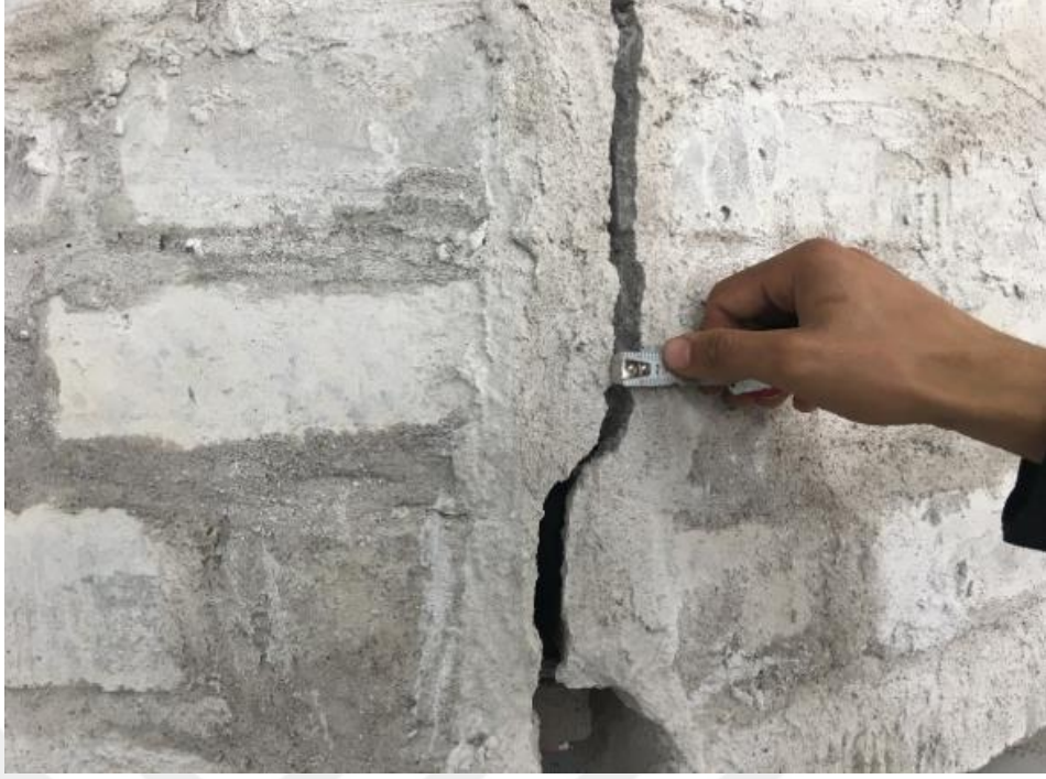
(h) Kubbede oluşan çatlak genişliği.
