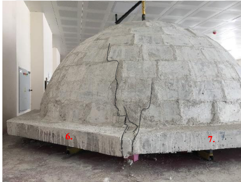
(d) 6.-7. kenarlardan başlayan çatlaklar.
