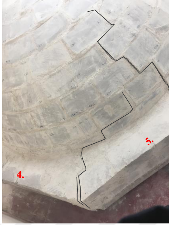
(c) 4.-5. kenarlardan başlayan çatlaklar.
