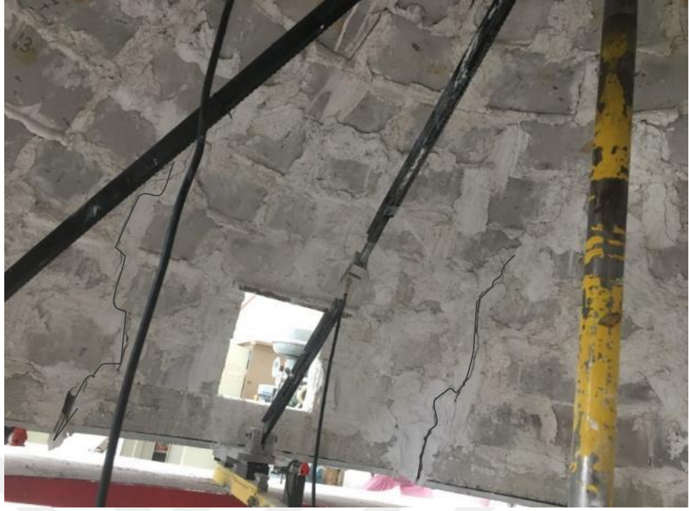
(h) Kubbe içinde oluşan çatlaklar.
