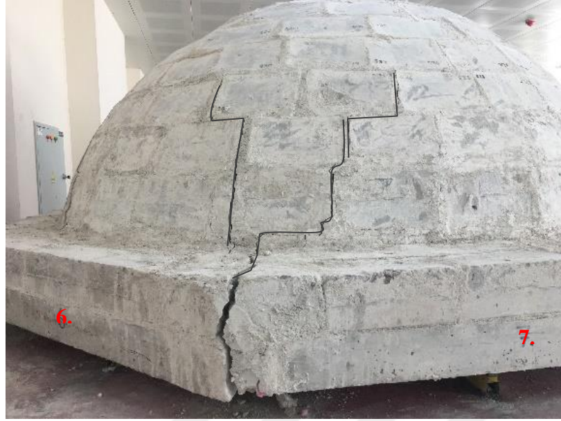
(e) 6.-7. kenarlardan başlayan çatlaklar.
