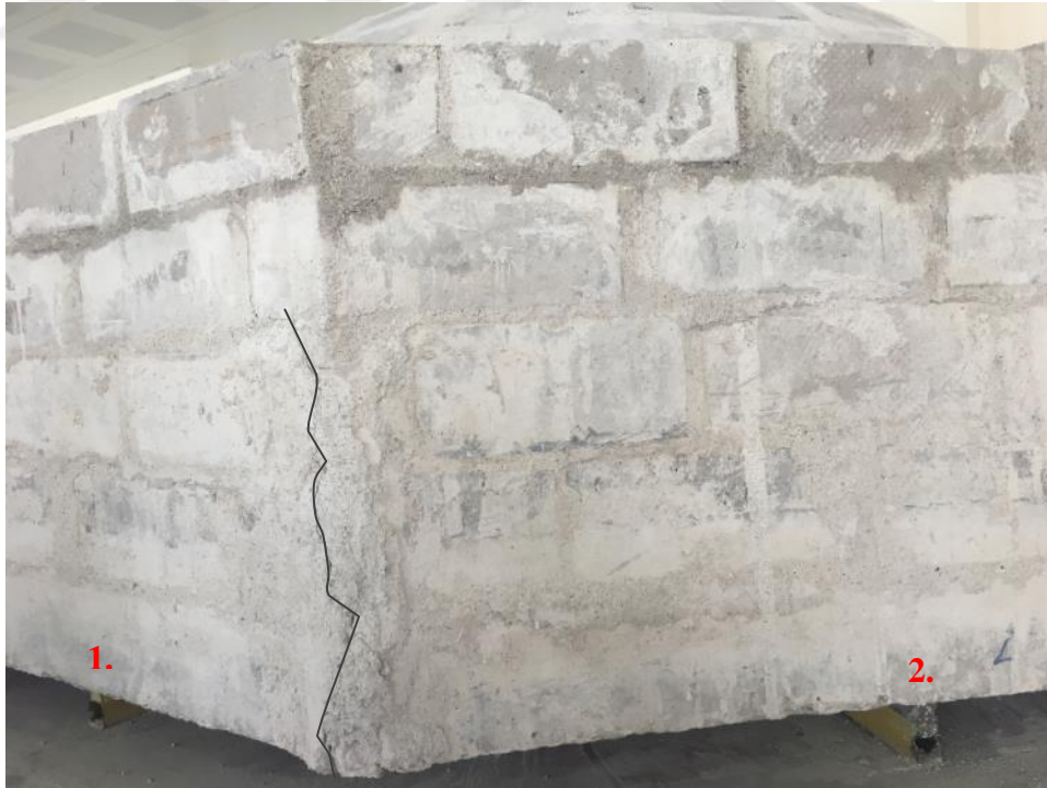
(a) 1.-2. kenarlardan başlayan çatlaklar.
