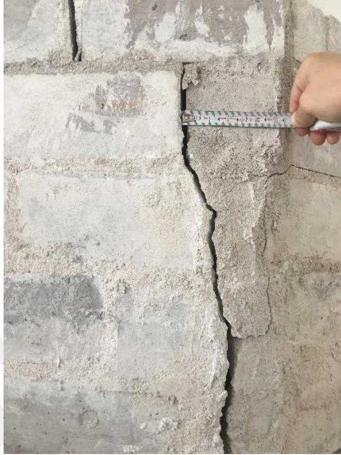
(f) Kubbe içerisinde oluşan çatlaklar.
