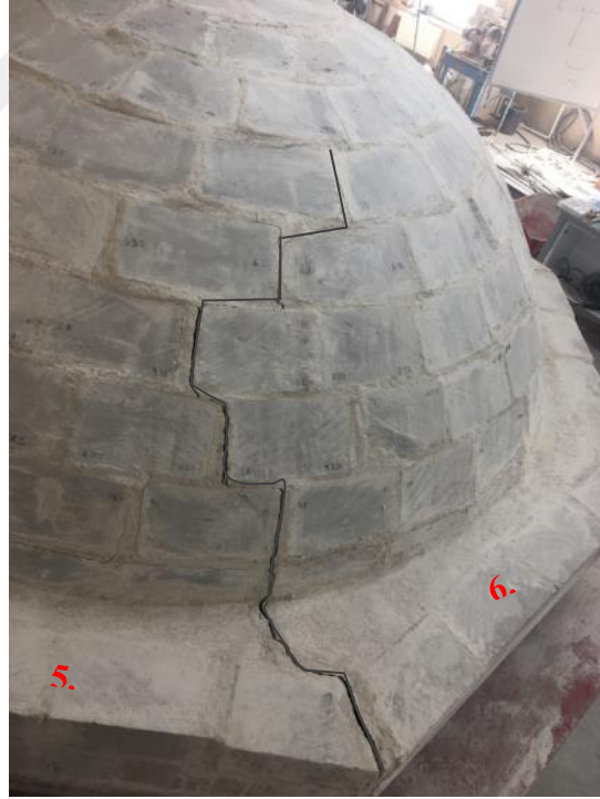
(d) 5.-6. kenarlardan başlayan çatlaklar.
