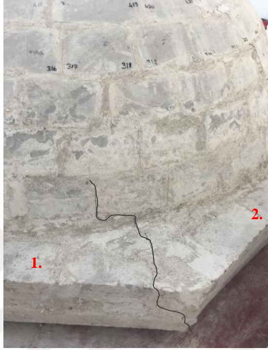
(a) 1.-2. kenarlardan başlayan çatlaklar.
