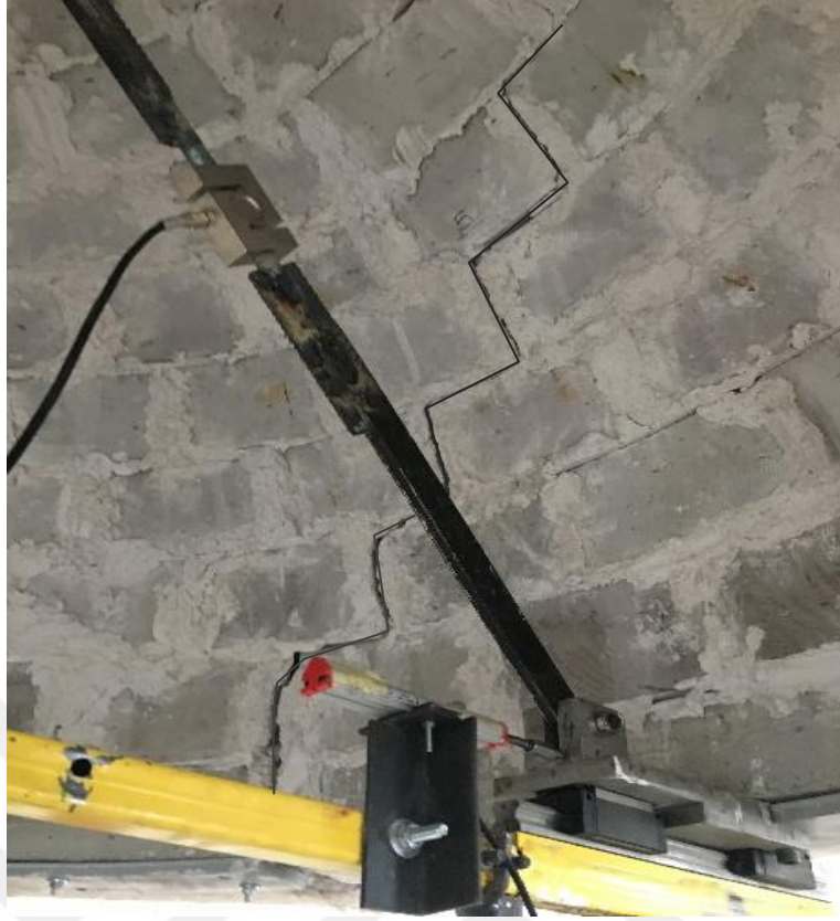
(f) Kubbe içerisinde oluşan çatlaklar.
