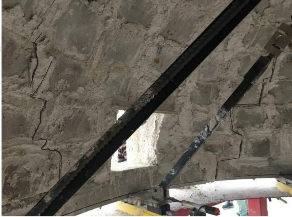
(g) Kubbe içinde oluşan çatlaklar.
