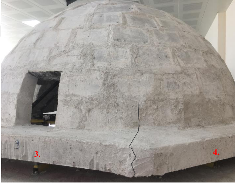
(c) 3.-4. kenarlardan başlayan çatlaklar.
