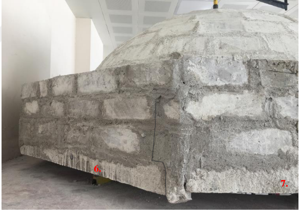
(d) 6.-7. kenarlardan başlayan çatlaklar.
