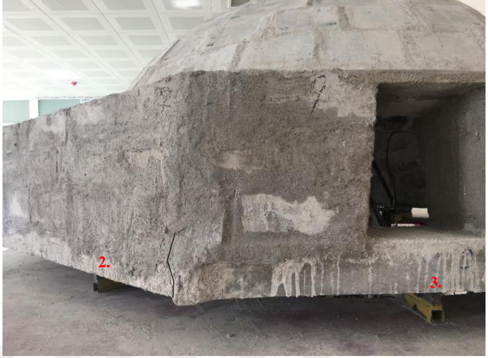
(c) 2.-3. kenarlardan başlayan çatlaklar.
