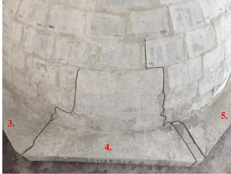
(b) 3.-4. ve 4.-5. kenarlardan başlayan çatlaklar.
