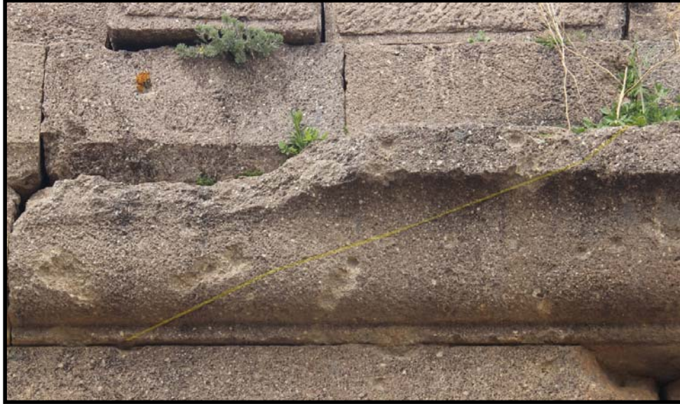
řekil 5.10. M-1 anıtının gneydoęu cephesindeki korniş bloęunda gzlenen atlak.
