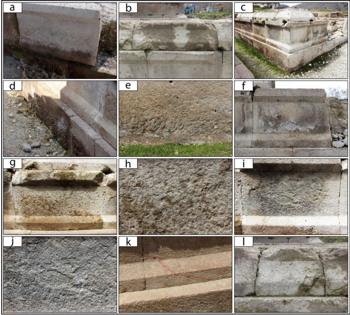
Şekil 5.5. M-2 anıtında gözlenen atmosferik kökenli bozunmalar; a) topraktan kapilarite ile yükselen nem alanı, b) üst kesimde dönemsel olarak yağışlarla yıkanan alanlar, c) yapı taşlarının, uzun yıllardan bu yana, toprak altında kalması nedeniyle, yüzeylerinde oluşan beyaz kabuk, d, e, f) yapı taşı yüzeylerindeki tuz kristalleşmesi (efflorescence), g, h) pul pul dökülme (flaking), i, j) tabaka halinde dökülme (scaling), k) çatlaklar (fracture), l) parçalanma (crumbling).
