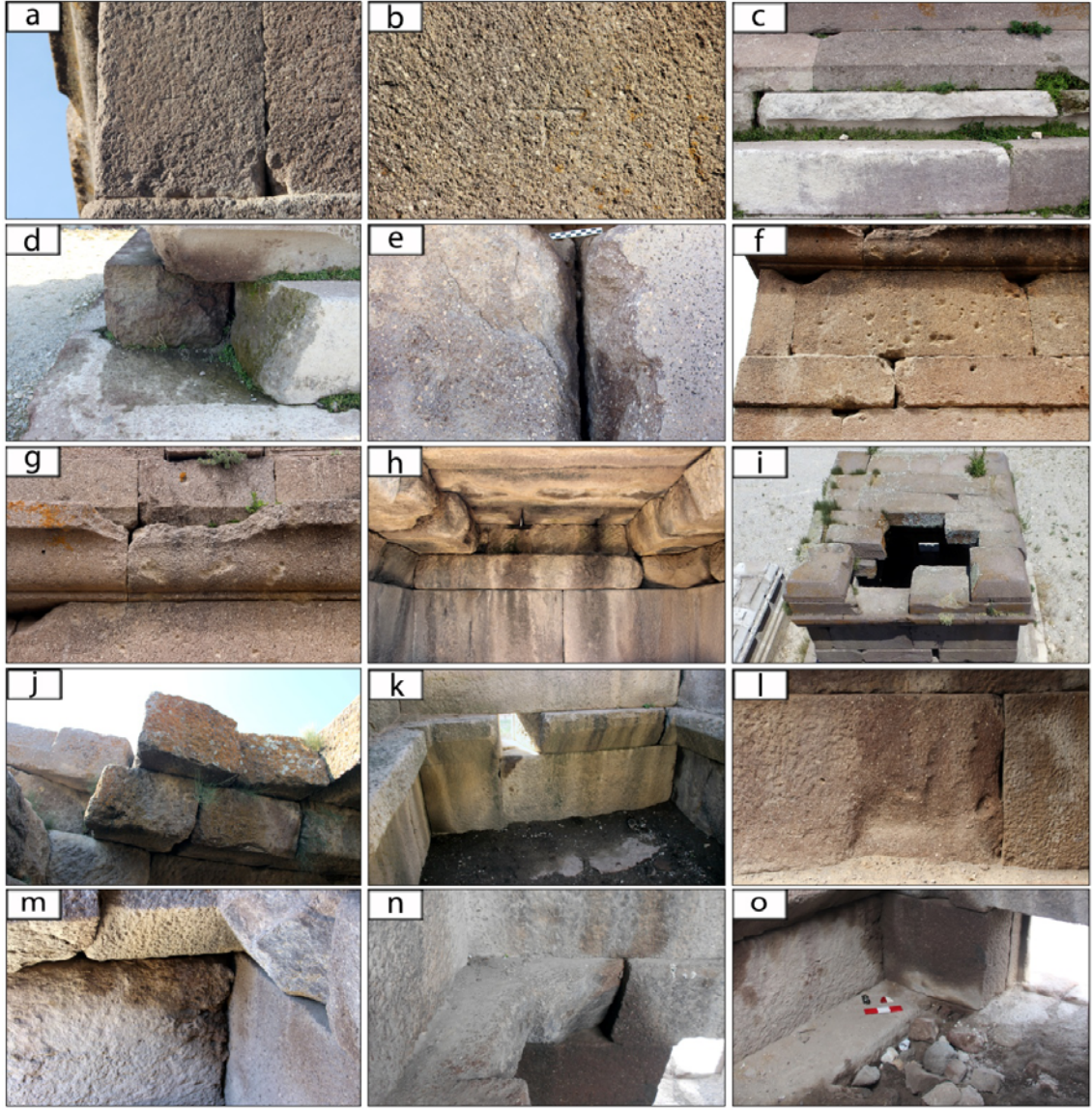
Şekil 5.7. M-1 yapısındaki antropojenik kökenli bozunmalar; a, b) haç biçimli dini figürler, c) kırılmış basamaklar, d) basamakta malzeme kaybı, e) yapı taşlarının derz ve köşelerindeki kırılmalar, f) kurşun izleri, g) üst örtü detaylarındaki kırılmalar, h) strüktür içerisine ve mezar odasına yağış kaynaklı su girişi, i) üst örtü kesimindeki blok eksilmeleri, j) üst örtü kesimindeki blok kırılmaları, k) mezar odasına giren yağış etkisi, l, m) mezar odası duvarlarındaki yapı taşlarında görülen bozunmalar, n) trapez biçimli konsoldaki malzeme kaybı, o) kaçak kazılar sonucunda oluşmuş çukur.
