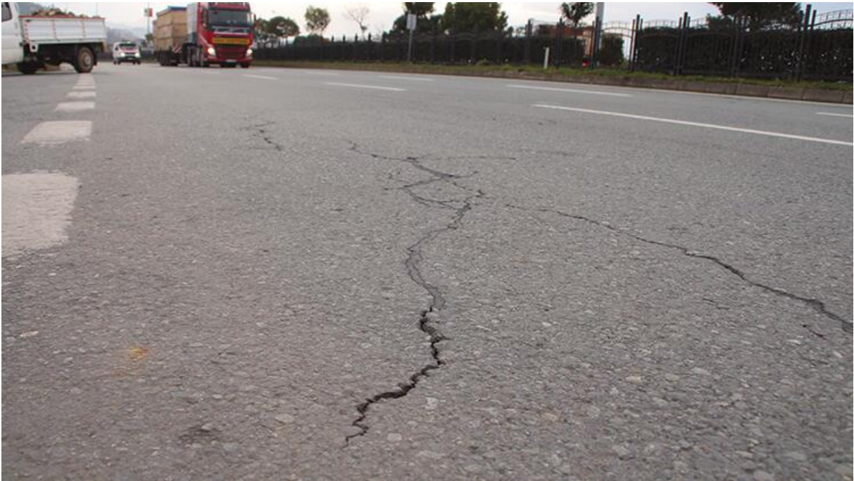
Şekil 2.2. Esnek üstyapı çatlak oluşumu
