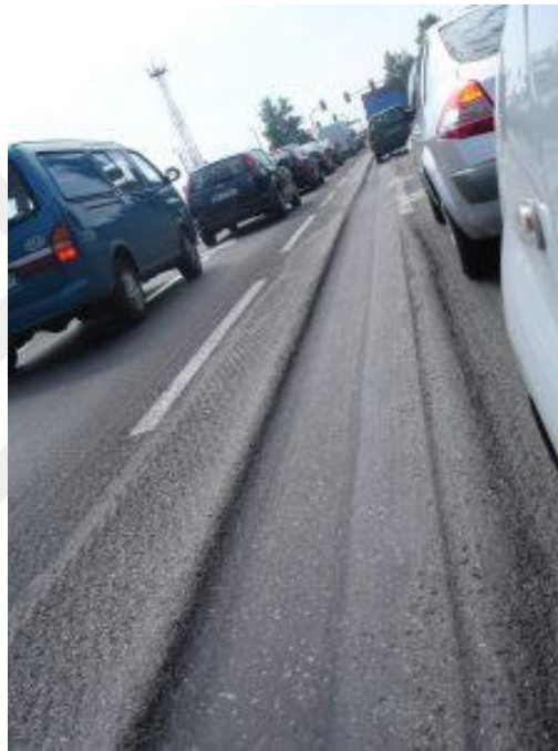
Şekil 2.4. Tekerlek izi oluşumu [34]
