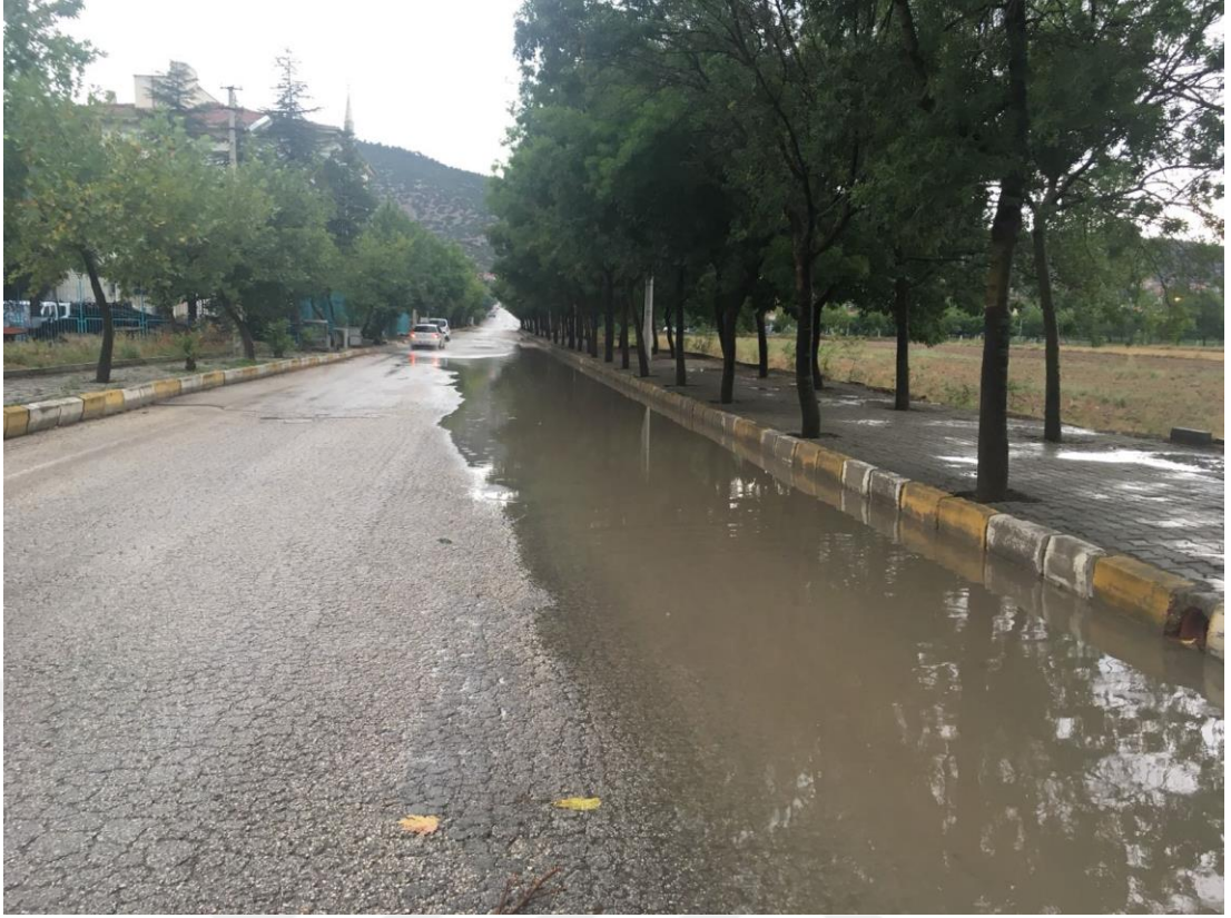
Şekil 4.16. Çünür-Mehmet Töngge Kavşağı Taşkın Meydana Gelen Alan
