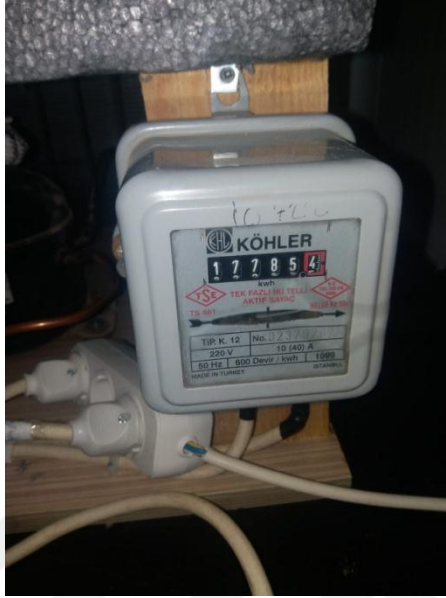
Şekil 3.7 Elektrik sayacına ait görseller
