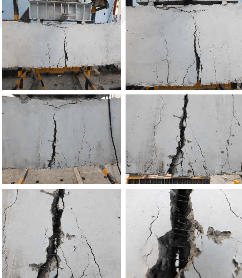
Şekil 3.52. No.8 kirişi hasar oluşumu
