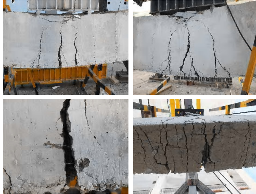
Şekil 3.38. No.6 kirişi hasar oluşumu
