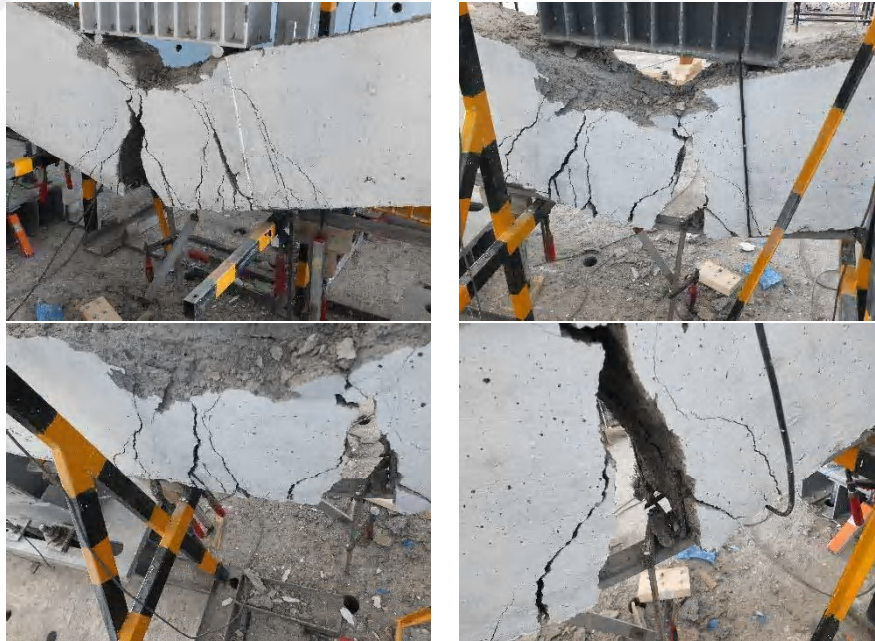
Şekil 3.3. No.1 kirişi hasar oluşumu
