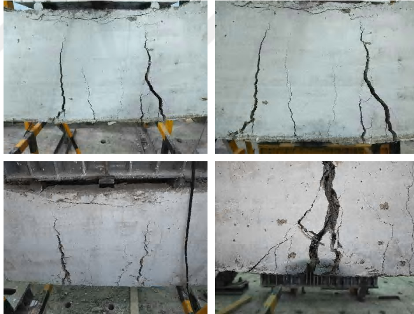
Şekil 3.45. No.7 kirişi hasar oluşumu
