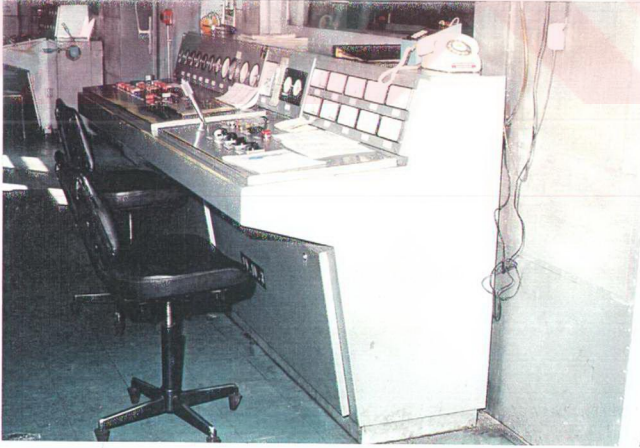
Şekil 4.2 Motor test ünitesi kontrol paneli
