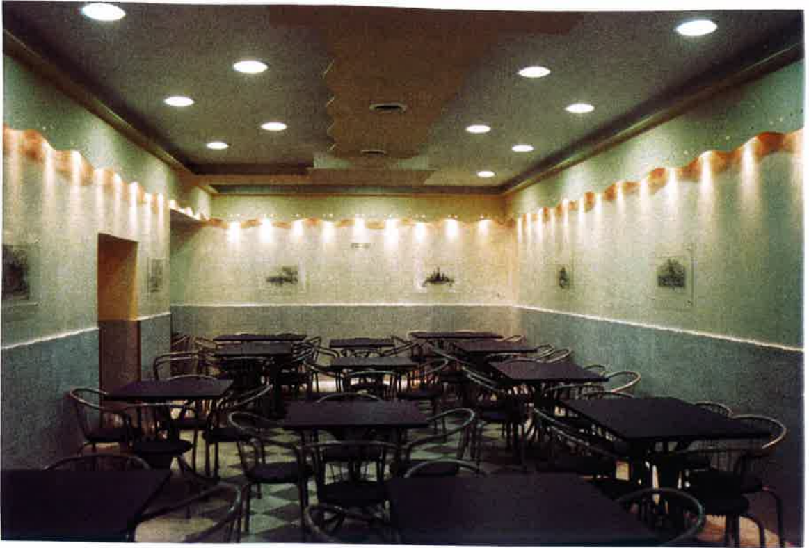
Şekil 4.1.12 Bir teşhir mekanında duvara uygulan gizli aydınlatma armatürleri
