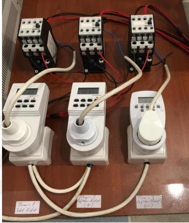
Şekil 2.35. Bakır levhaya lehim yapılan kabloların kontaktöre bağlanması ve kontaktörün timer ile olan bağlantı sistemi
