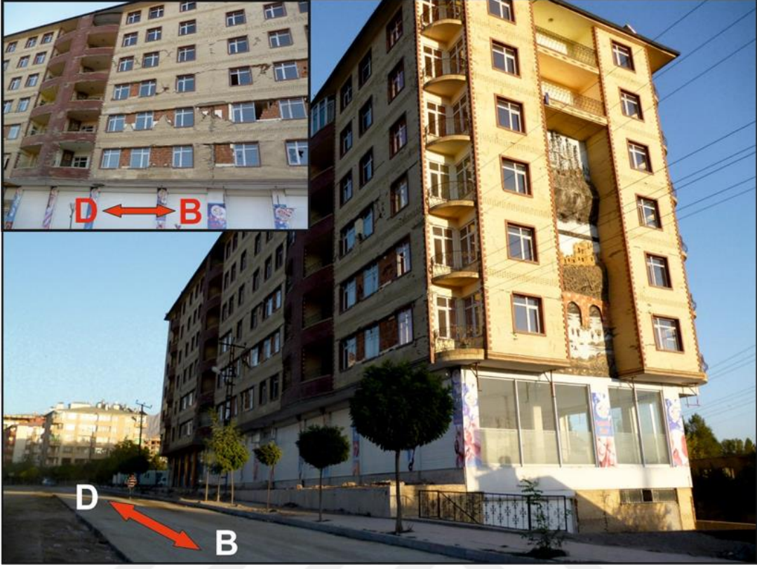
Şekil 4.179. Betonarme yapılarda D-B salınım sonucunda gerçekleşmiş makaslama çatlakları.
