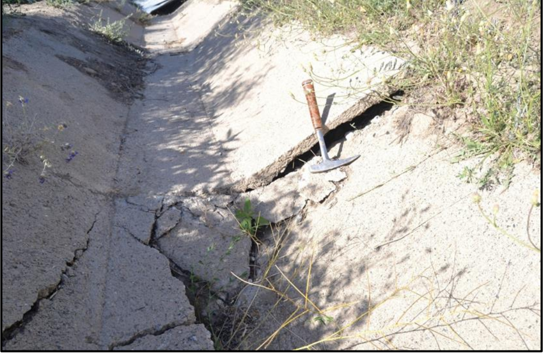
Şekil 4.162. Su kanallarında depremle birlikte gelişen deformasyon, Bardakçı Köyü yakını, bakış yönü KB.
