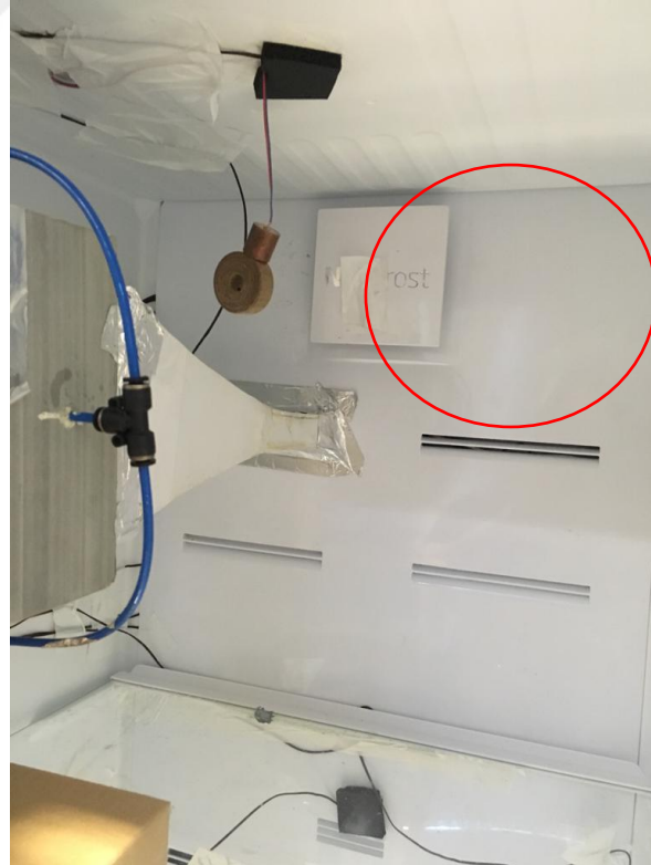
Şekil 4.2: Taze gıda kabini hava dağıtım fanı
