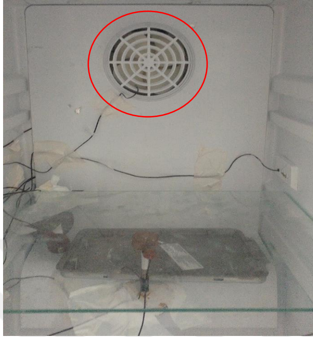
Şekil 4.1: Dondurucu kabin hava dağıtım fanı
