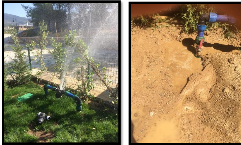
Şekil 4.29. Aktif sulama sistemi fazla basınç sonrası malzemede hasar oluşumu
