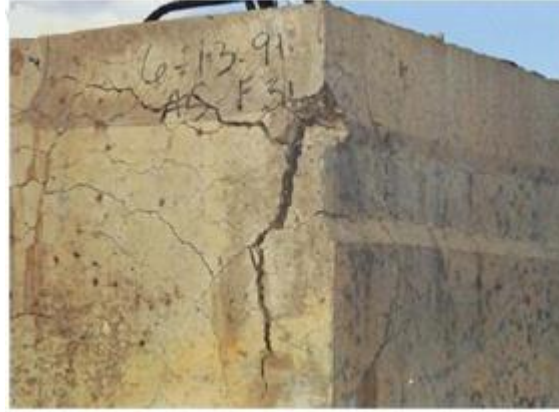
Şekil 1.1. ABD’de prefabrike bir kiriş elemanda DEF oluşumu (Baradan vd 2010).
