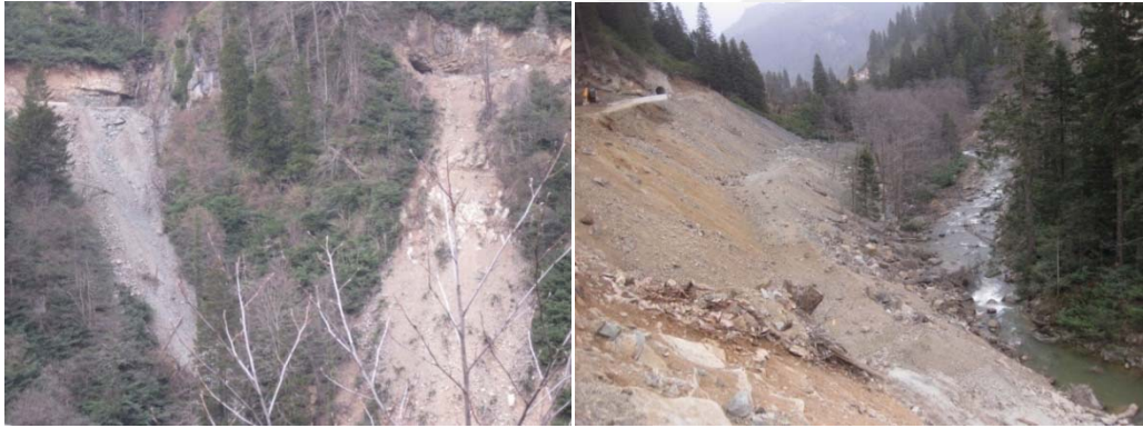
Şekil 4.35. Su iletim hattının kanal yapımı esnasında yamaçtan akan malzeme
