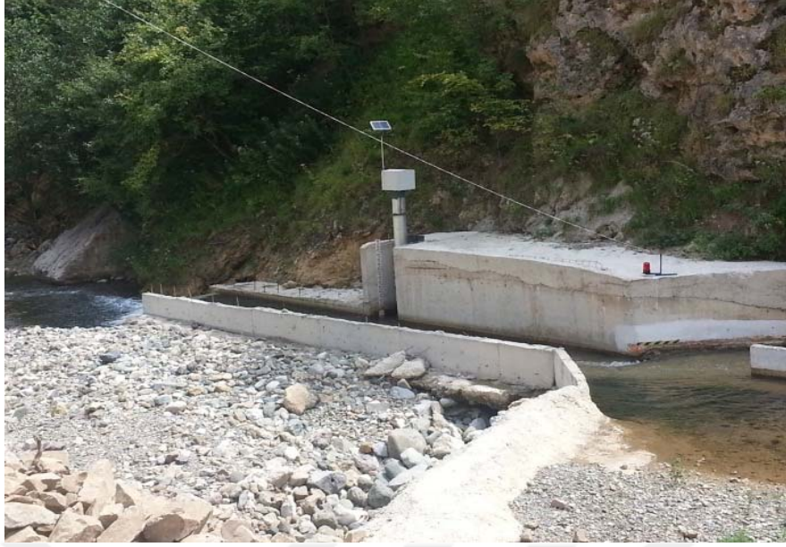
Şekil 4.46. DSİ tarafından HES firmalarına yaptırılan cansuyu ölçüm kanalı ve CAGİ'si
