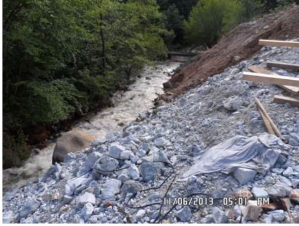
Şekil 4.39. Giresun Pazarsuyu Vadisi'nde yapılmakta olan HES için yapılan iletim kanalı inşaatının oluşturduğu tahribat
