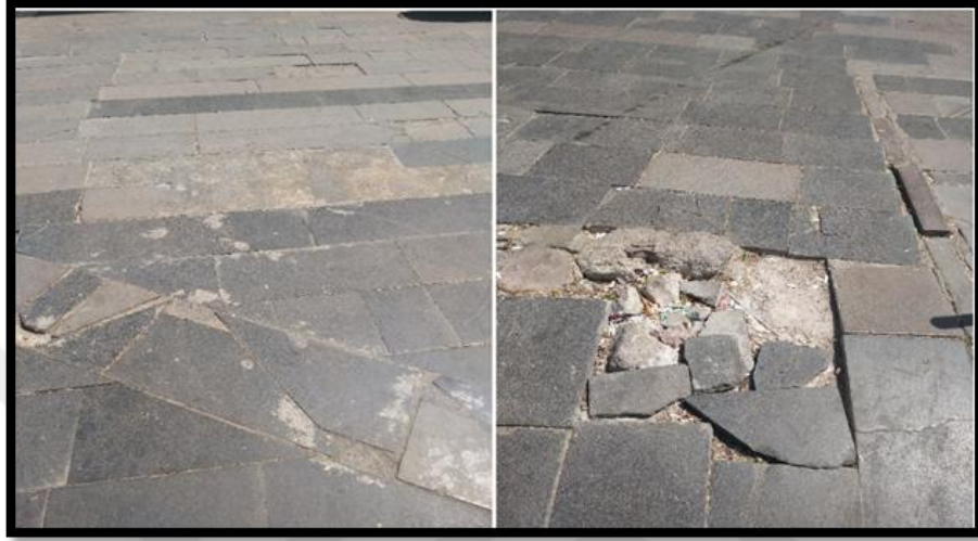
Şekil 4. 3. Güres Caddesi’nin deformasyona uğramış zemin döşemesi (Kaynak: Kendi arşivimden)
