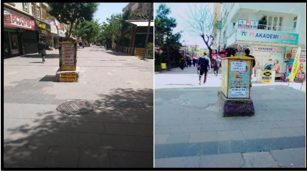
Şekil 4. 4. Güres Caddesi’nde yanlış konumlandırılmış elektrik trafoların ve elektrik panolarının konumu (Kaynak: Kendi arşivimden)
