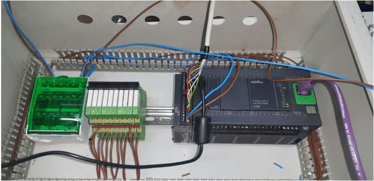
Şekil 3.19. PLC tesisatının yerleşimi.
