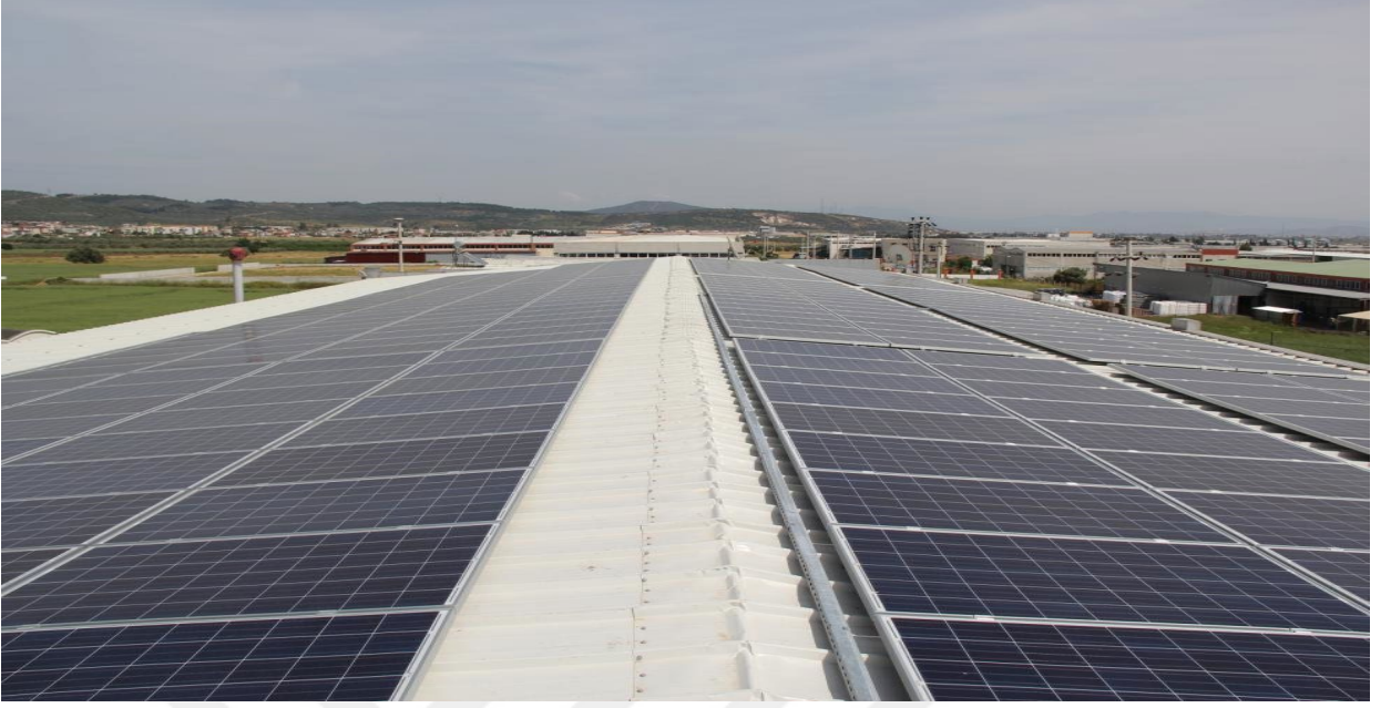
Şekil 3: Cemer kent ekipmanları 400 kWp çatı uygulaması-(2013 İzmir)
