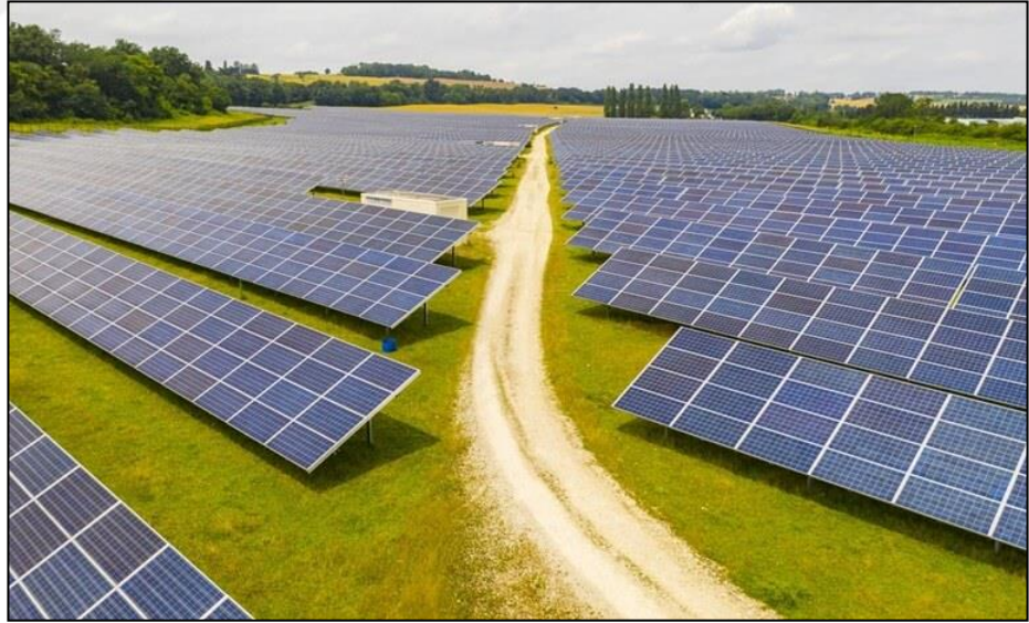
Şekil 4.5 Fotovoltaik güneş enerji santrali
