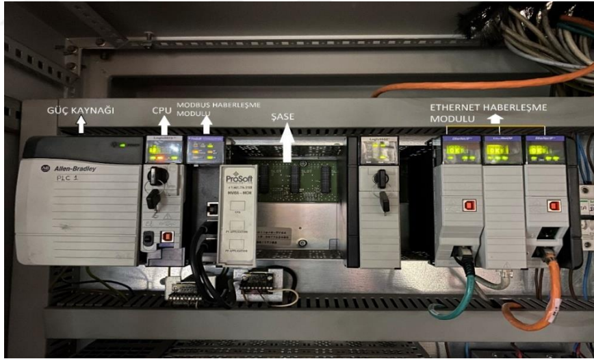
Şekil 4.4. Rockwell automation 1756-173 controllogix PLC
