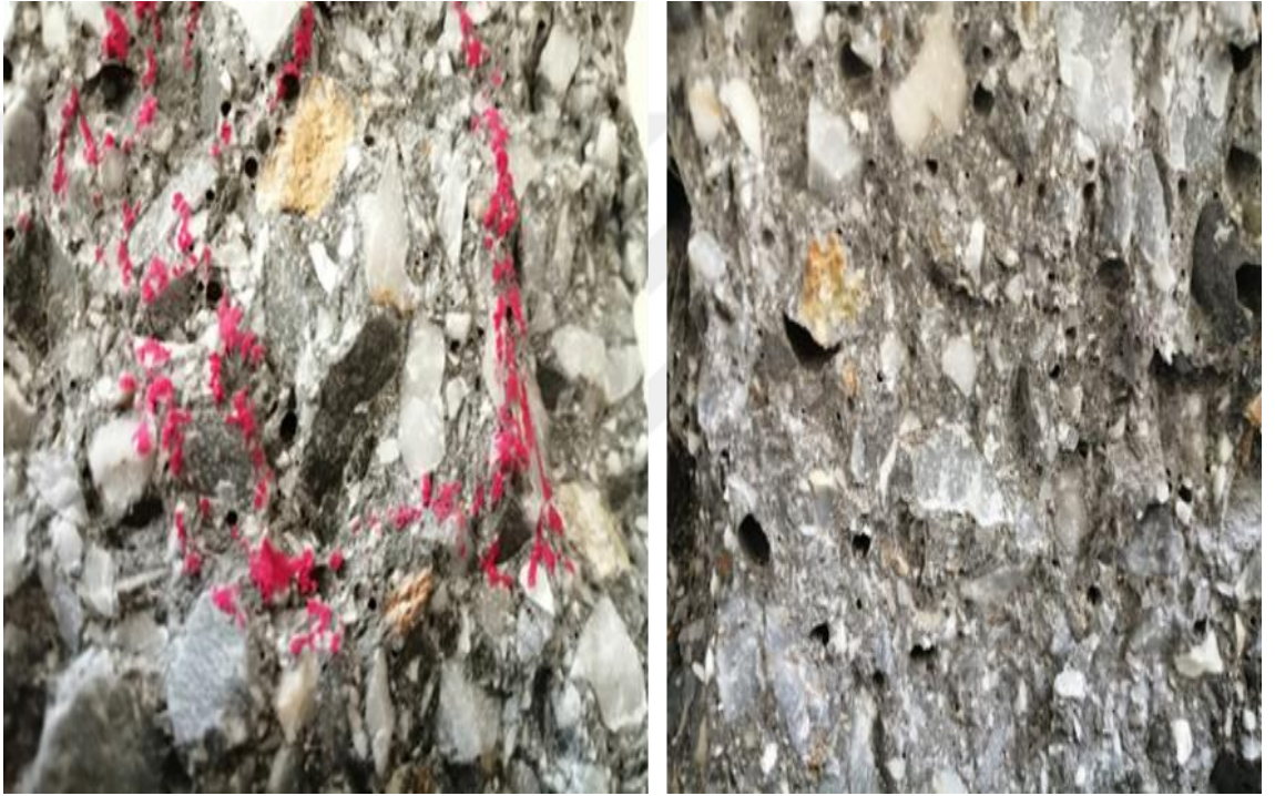
Şekil 5.3. Betonun kırılma yüzey
