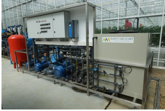
Şekil 3.2. Sera sulama ünitesinin bir bölümü.
