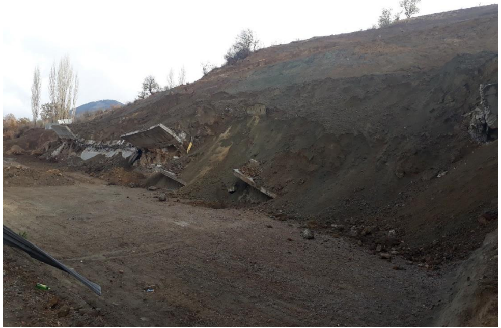
Şekil 4. 2 2019 Yılında Yapılan Kazıkların Temel Kazısı Sonrası Kırılması (Doğu Yönü) (Pala, 2019)
