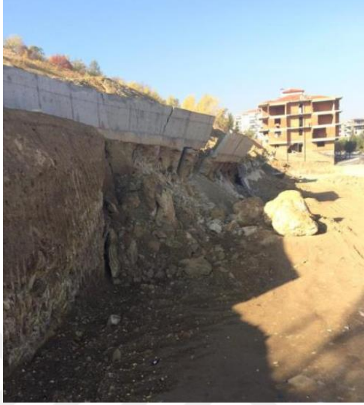
Şekil 4. 1 2019 Yılında Yapılan Kazıkların Temel Kazısı Sonrası Kırılması (Batı Yönü) (Pala, 2019)
