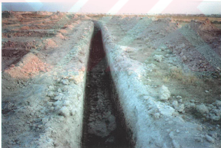
Şekil 3.5. Deneme alanının üç tarafını çevreleyen drenaj kanalının görünümü.
