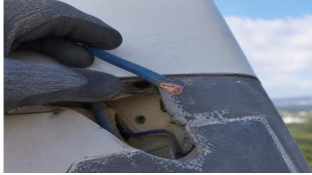
Şekil 4.5.11.1. Yıldırım sonrası hasar görmüş LPS sistemine ait tip reseptör hasarı
