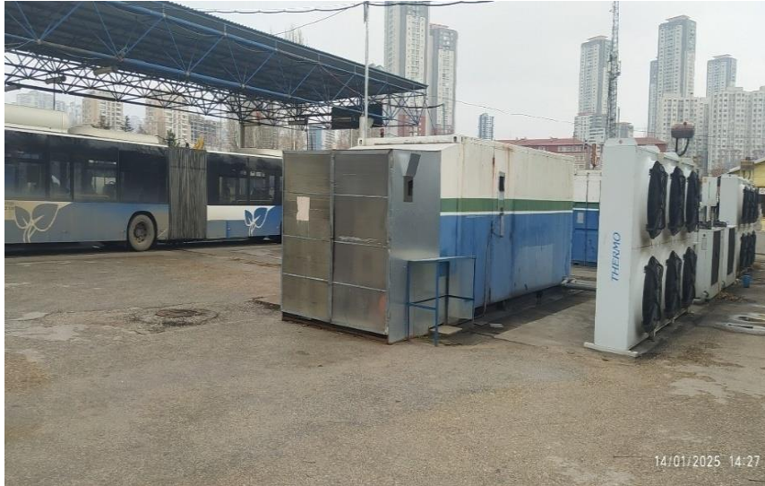
Şekil 4.10 CNG dolum istasyonunun görüntüsü
