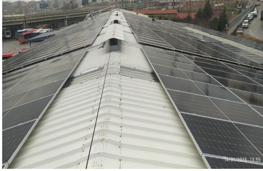
Şekil 4.9 Elektrik atölyesinin güneş paneli yerleşimi
