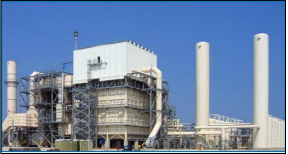
Şekil 1.8. Buhar metan reformasyonu tesisi ( http://www.lindeengineering.com )
