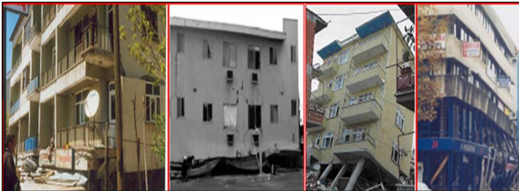
Şekil 1.6 : Zayıf kat düzensizliği nedeniyle oluşan deprem hasarları(Kaushik & Jain, 2007).
