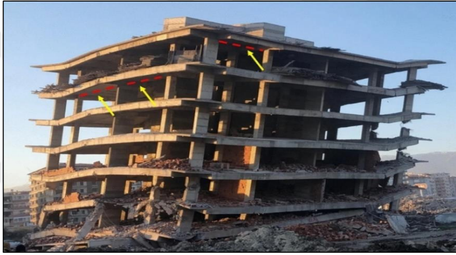
Şekil 1.2 : Zemin kat mekanizması hasarı, Elbistan depremi (06.02.2023 (Ayso et al., 2024).
