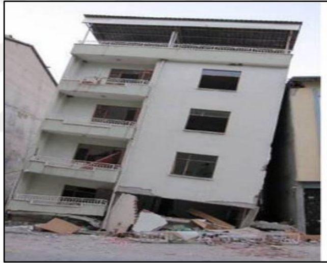
Şekil 1.5 : Yumuşak kat mekanizmasına bağlı bina hasarı 2011, Kütahya-Simav depremi, (Yılmaz & Avşar, 2013).
