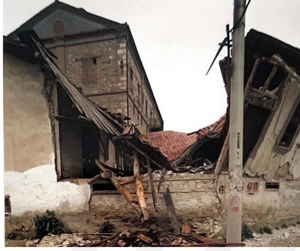
Şekil 5.14: Çöken Ek Yönetim Binası. 1996 (Denizli İl Kùltür ve Turizm Müdürlüğü Arşivi)
