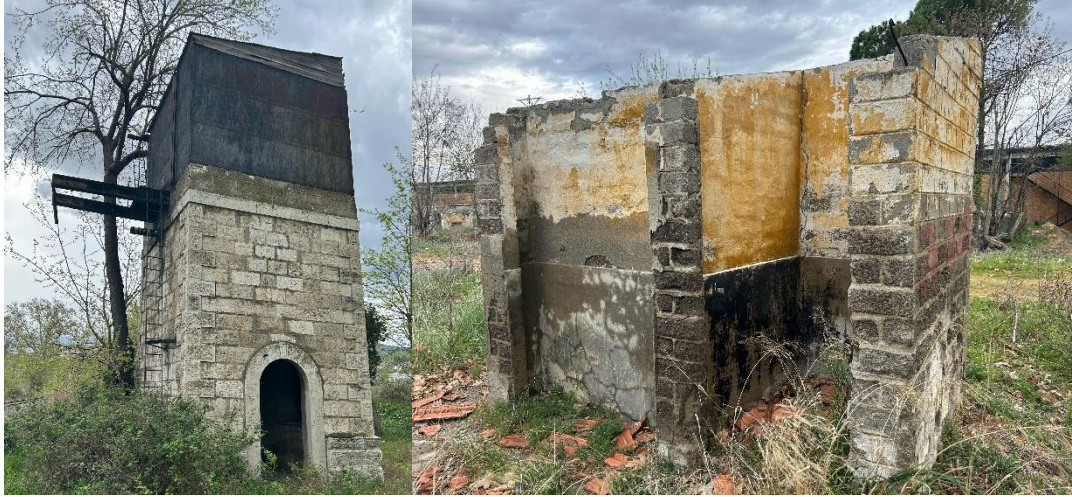
Şekil 5.107-108: Su deposu ve Umumi Tuvalet (Yazar arşivi Mart 2025)
