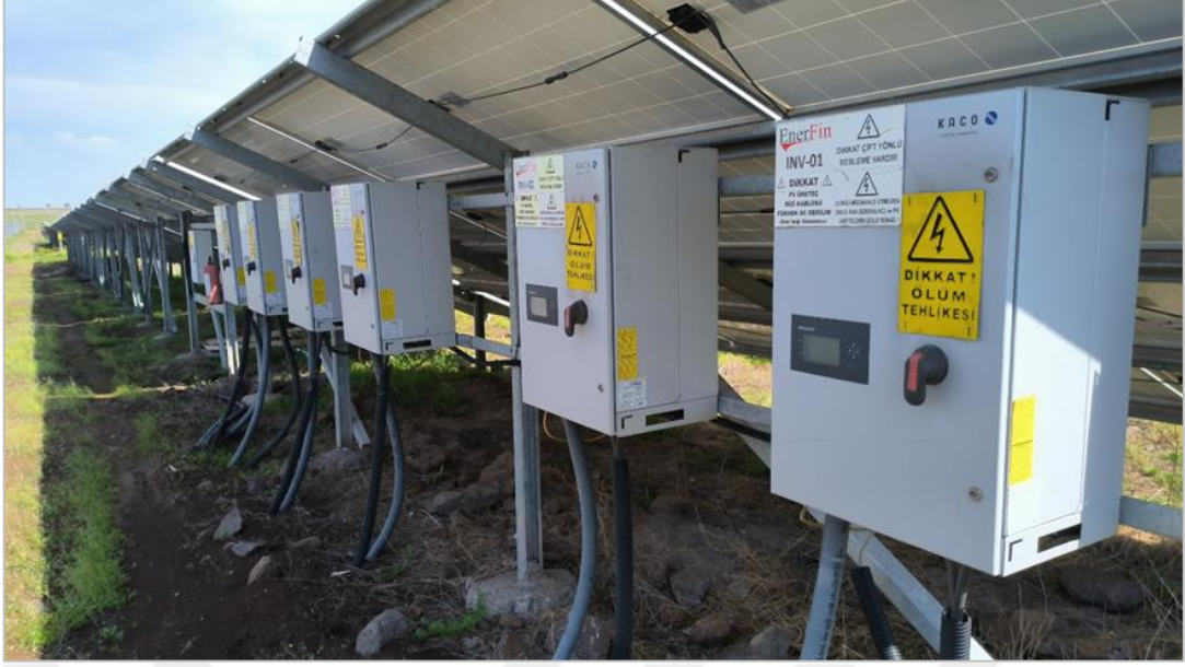
Şekil 72. PV dizisine bağlanan invertörler
