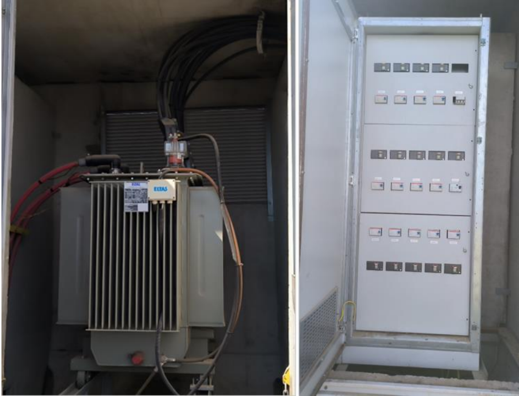
Şekil 77. Şebeke trafosu (solda) ve invertör (sağda) termik şalter panosu
